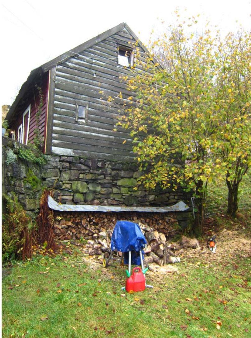
Eldhusets vestfasade ser trist ut med dårleg borkldning og vindskier. Muren har byrja å gli ut mot nord. Dette bør stoppast så fort som muleg.
