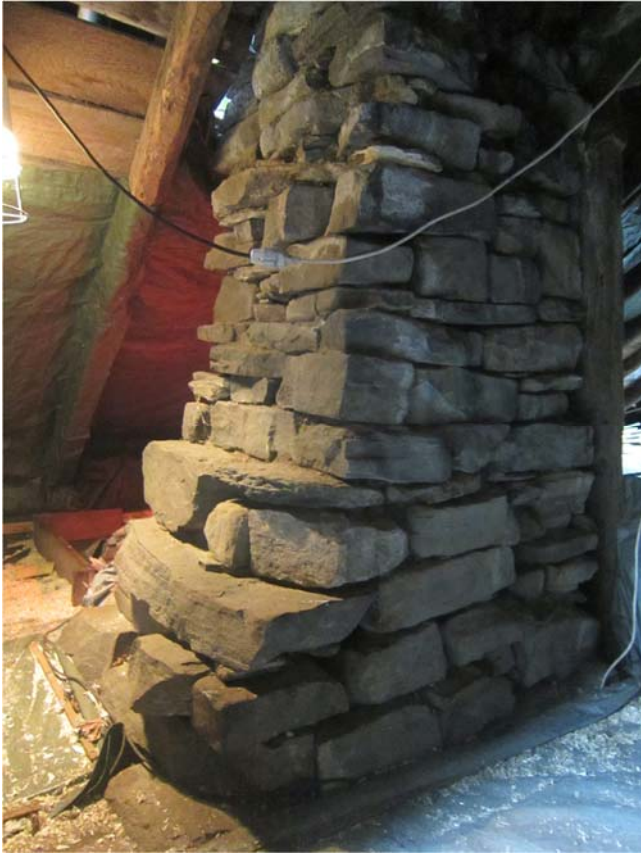
Pipemuren til eldhusomnen slik han går gjennom loftet.
