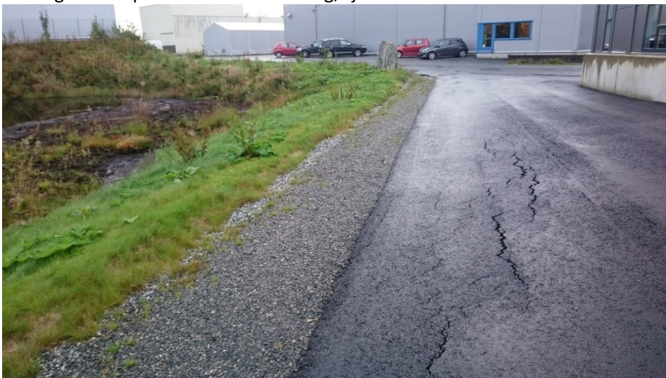
Setningsskader på veg
