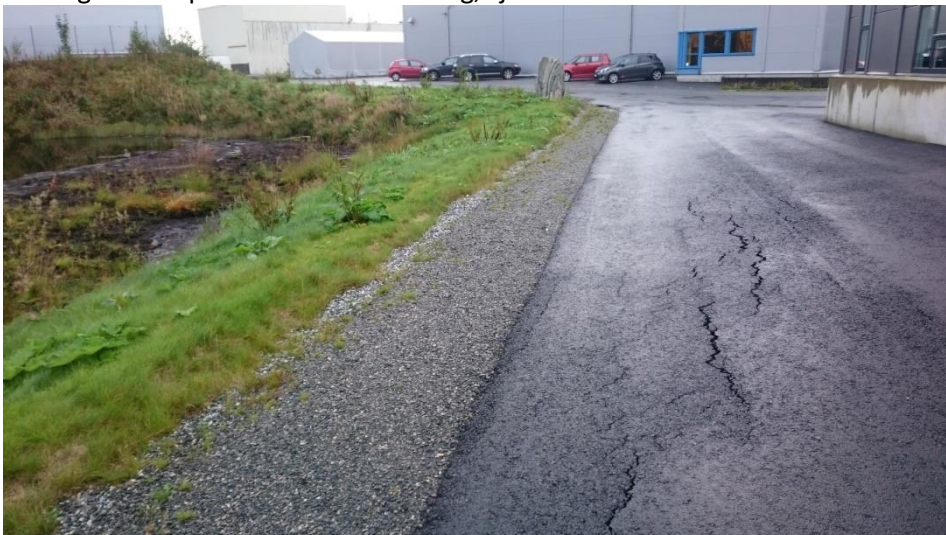
Setningsskader på veg
