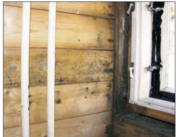
Muggvekst som en følge av kondensering av varm, fuktig luft på kalde flater.
