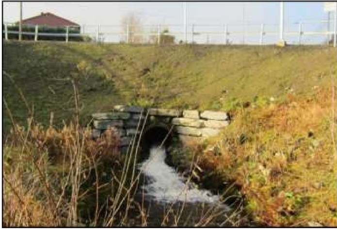
Figur 2; Utløp frå stikkrenna under fylkesvegen ved Fossekrysset.
