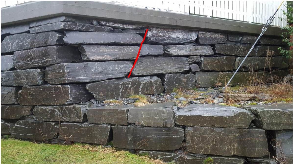
Figur 3-6: Bilde viser område av muren med dårlig forband (bandtjuv indikert med rød strek). Endeavslutningen (hjørnet) på muren er også dårlig utført i dette området.
