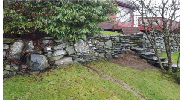
Figur 3-5: Bildet viser observert skade/utrasing i del av mur med begrenset høyde.
