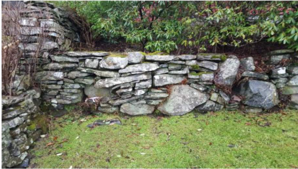
Figur 3-4: Bildet viser observert skade/utrasing i del av mur med begrenset høyde.
