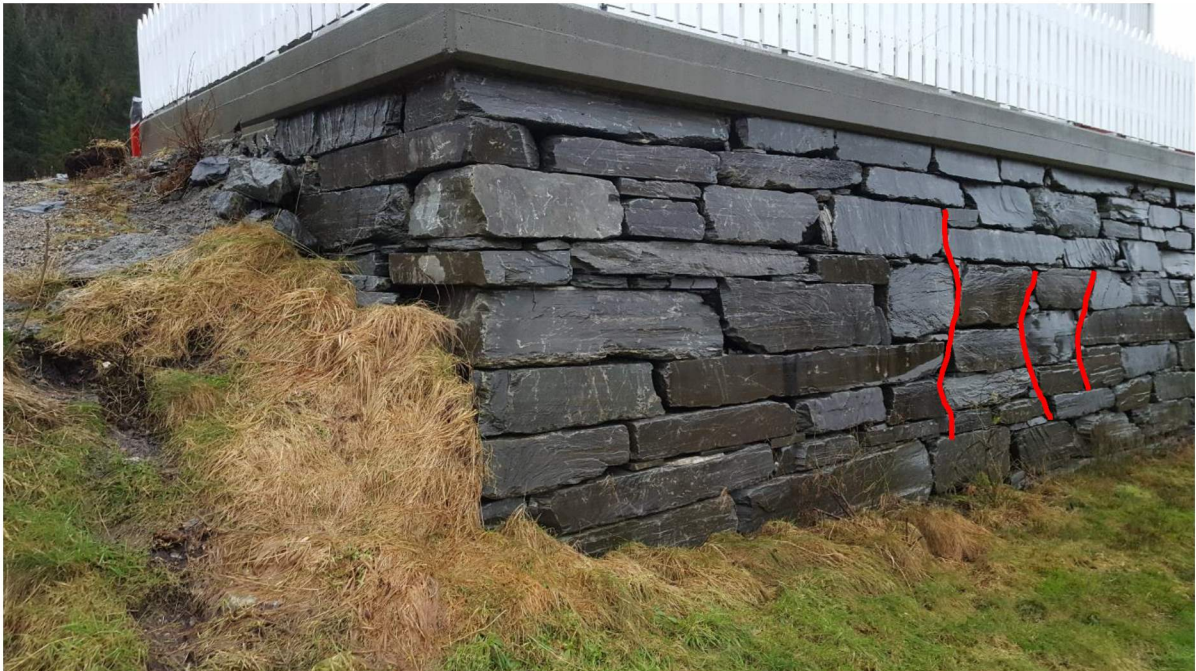
Figur 3-8: Bilde viser område av muren med dårlig forband (bandtjuv indikert med røde streker).
