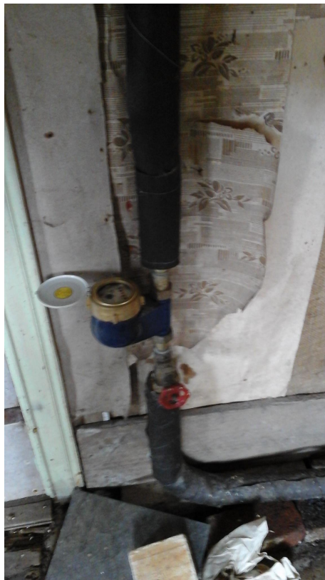
Skjema: "Sjekkliste etter utført arbeid: Plugget vanntilkobling." Filnavn: TempImage.jpg
