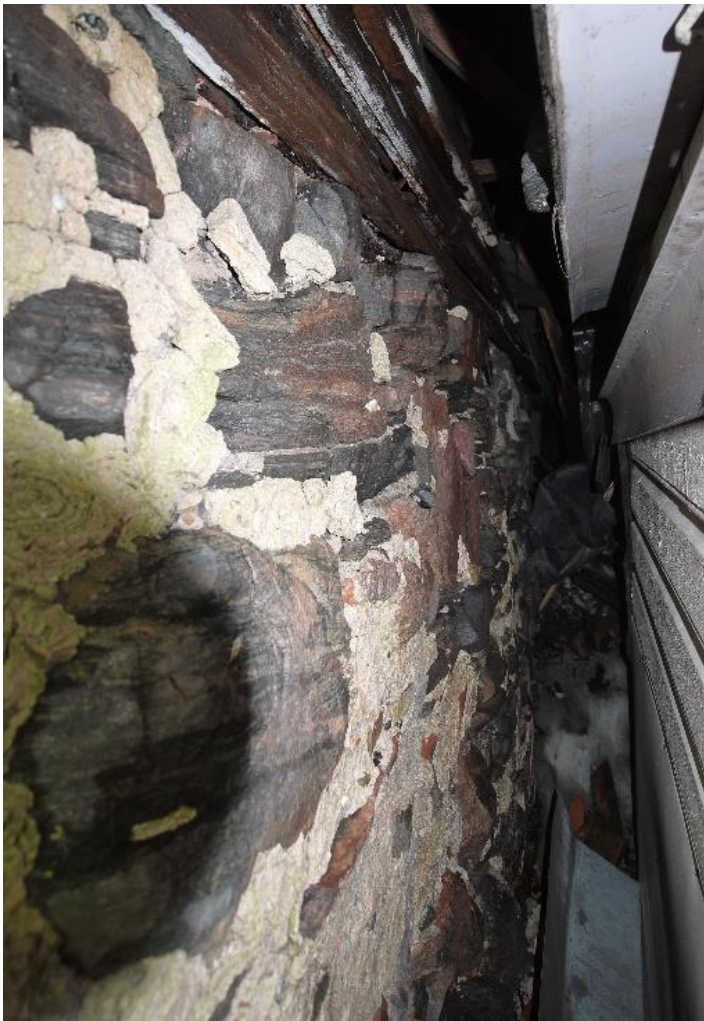
Bildet over: Utside kjellervegg dråpefall, utvasket kalk pga vann fra renne
