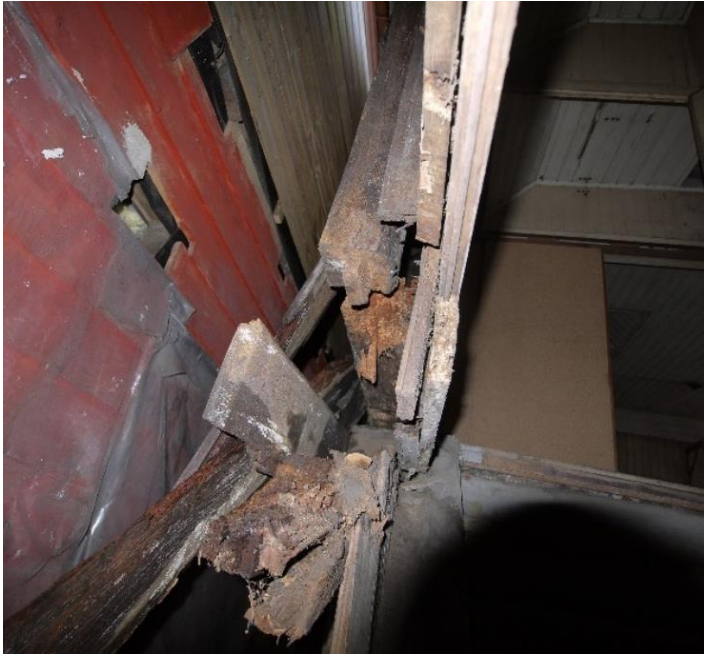
Bildet over: utrast yttervegg 1.etg
