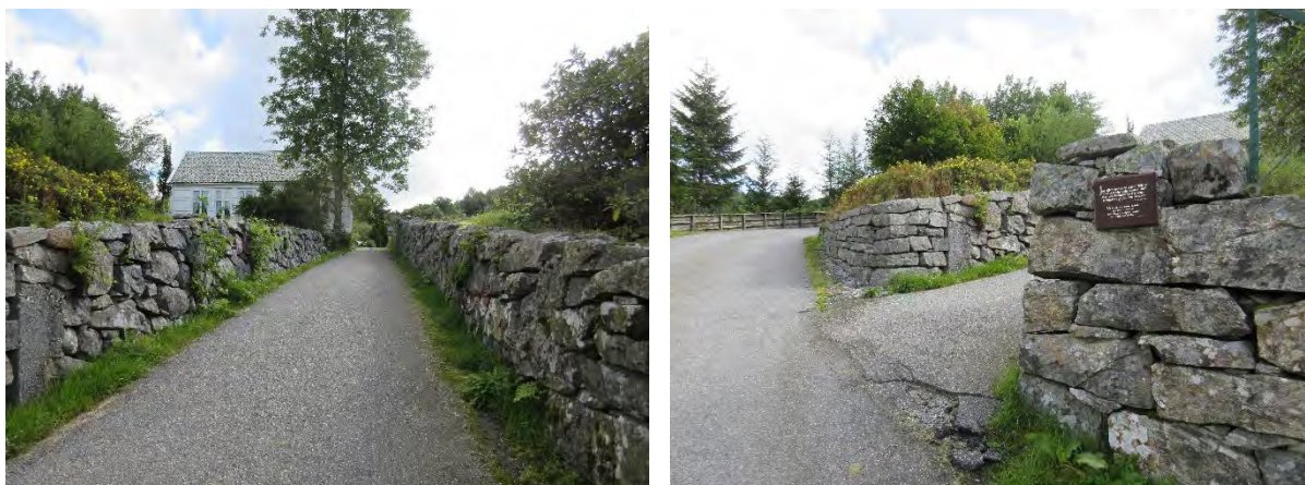
Figur 6-8 Foto til høgre viser gangveg med tilhøyrande murar på begge sider. Foto til høgre viser nedre del av gangveg som må omarbeidast. Foto: Asplan Viak AS.
