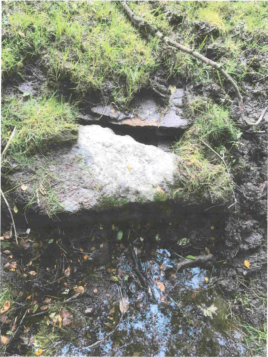
Her er åpningen på kisteveiten som skal sluke unna dette vannet
