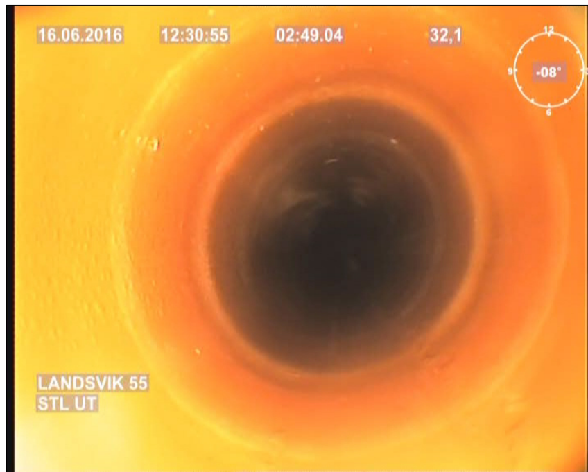
Foto: 1__Landvik 55S_SectionnameStl Skjult kum14345216062016.jpg 32,4m, Deformasjonen er 5 % eller mindre av rørdimensjonen, #C, Vertikalt - rørhøyden har blitt redusert, fra 12 til 12 Kl.
