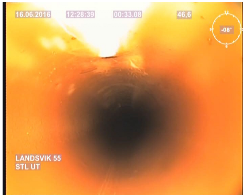
Foto: 1__Landvik 55S_SectionnameStl Skjult kum14305516062016.jpg 46,6m, Deformasjonen er mellom 5 - 15 % av rørdimensjonen, fra 11 til 01 Kl., Punkt deformasjon
