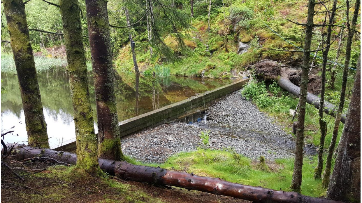
Fig. 7. Fangdam nr. 3. Det vart lagt fram plan for dammen og Kjetil og Frode Tufte hevda at den ikkje var bygd etter planen då «demninga» var om lag 25cm for låg. Dette har stor innverknad på vasspeilet i det flate lendet oppstrauts dammen. Dammen var òg lekk, slik at ein del finstoff rann vidare nedover i vassdraget.
