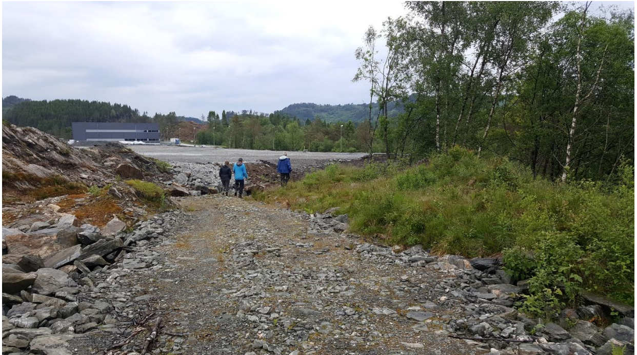
Fig. 5. Etablering av industriområde. Fangdammane i fig. 6. er nede til høgre for personane i biletet.
