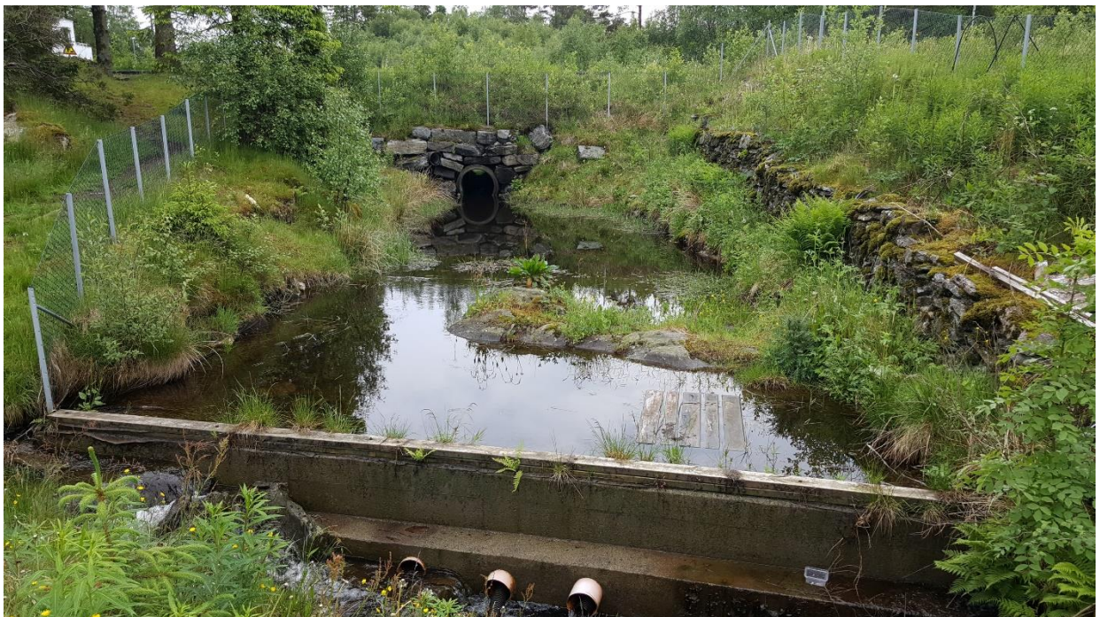
Fig. 10. Fangdammen er plassert nedstrøms ein mindre tilkomstveg til bustader/anna føremål, men påverkar området oppstrøms vegen (fig. 9). I bakkant av hovudvegen som er rett bak der biletet er teke, er Kvernhusbekken lukka over eit område på om lag 200m som er dyrka før den kjem ned i fangdam nr. 5. Det er etablert røyr i demma som gjer at dammen raskt vert tømd ved lite tilsig inn mot dammen.
