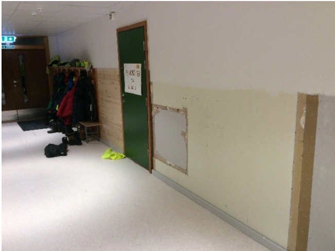
Viser vegg mot klasserom hvor det er fukt bak panel og gips.
