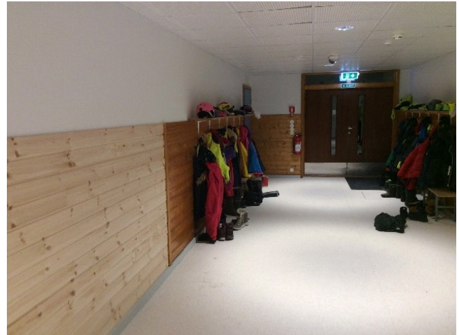
Viser vegg mot det andre klasserommet hvor det er fukt i vegg.
