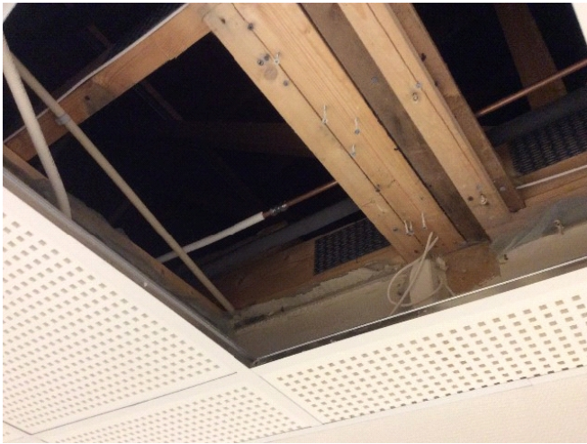
Viser kobberrøret hvor lekkasjen oppstod.
