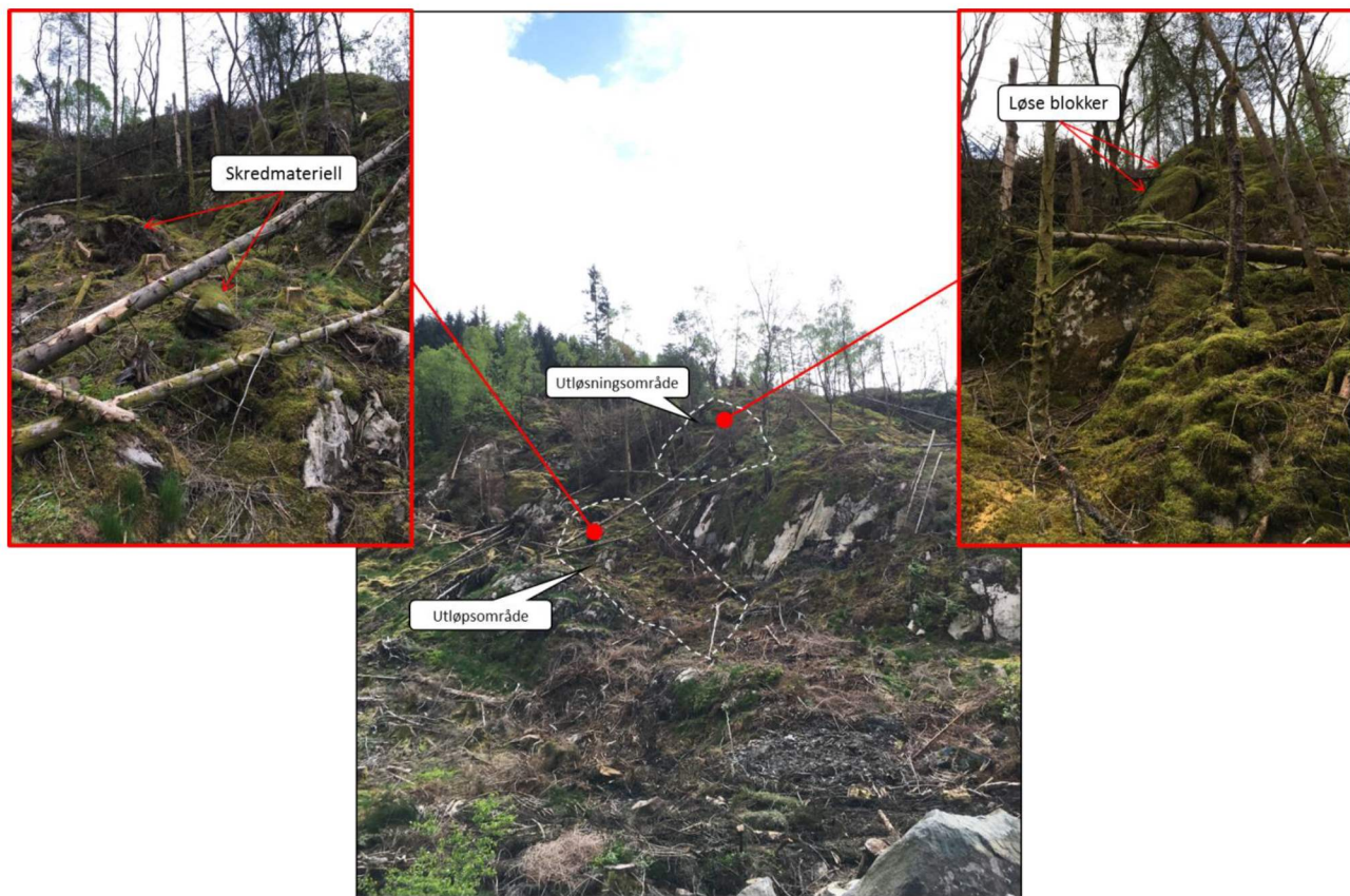
Figur 8. Foto fra befarings. Bildet i senter, viser området hvor det er registrert løse blokker og området hvor det er registrert skredmateriell. Bildet oppe til venstre viser blokker som har falt ut fra skråningen (historiske skredhendelser). Bildet oppe til høyre viser området hvor det er registrert løse blokker.
