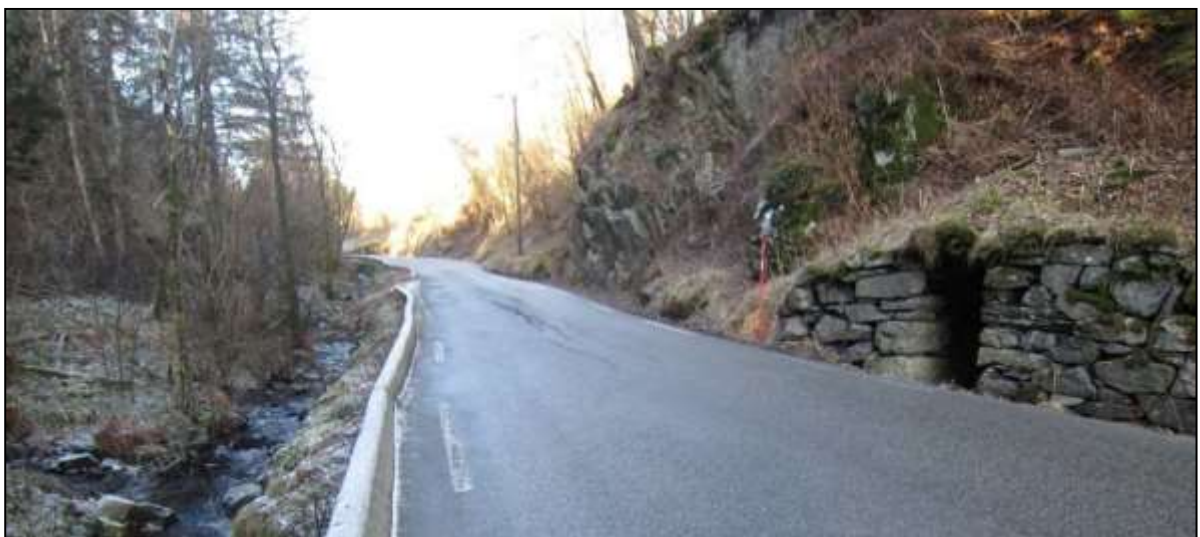
Figur 32; Bekk og jordkjellar tett opp mot vegen. Nordover frå Sundet pregar bratt sideterreng på begge sider av vegen reiseopplevinga eit godt stykke.
