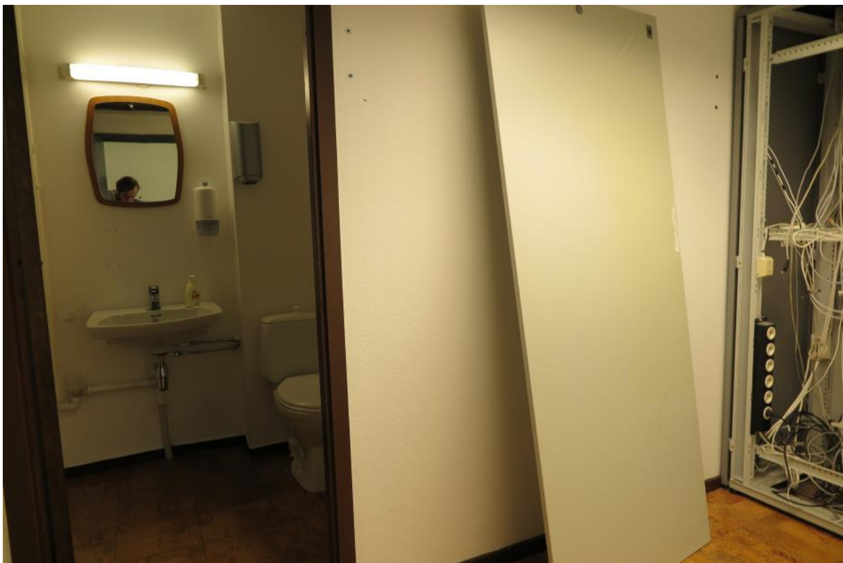
Garderobe og toalett ved rømmingsveg.
