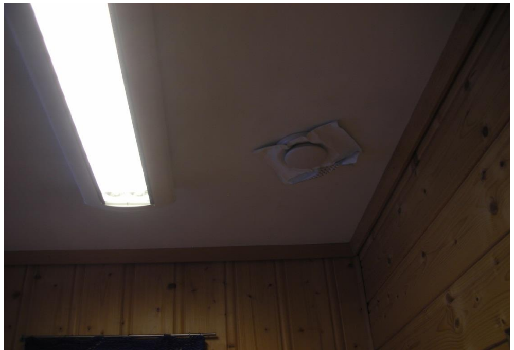
Avtreksventil – tettet pga trekk.
