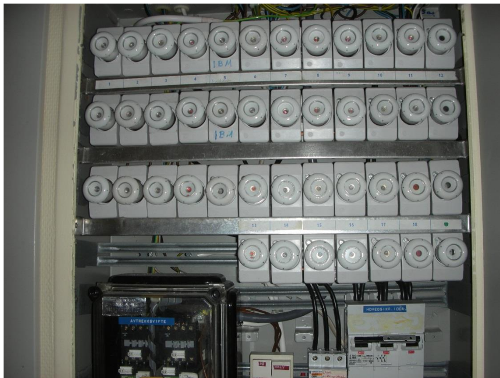
Tavleskap 2.etg - skrusikringer
