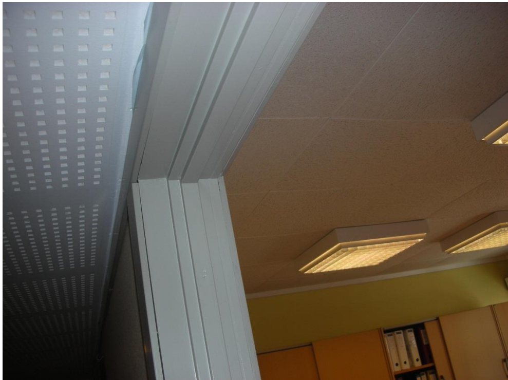
Korridor 2.etg – Lav takhøyde, himling like over dør.
