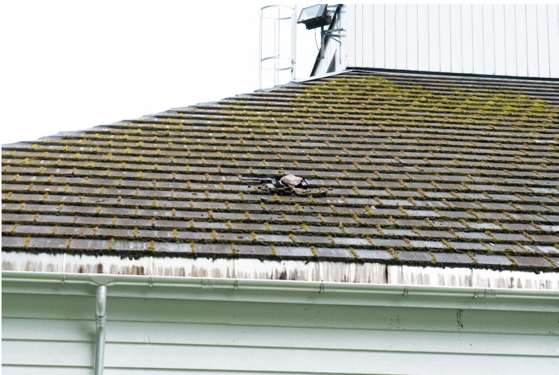
Figur 3-4. Stein som har truffet taket og knust skiferheller. Ingen steiner gikk igjennom taket.
