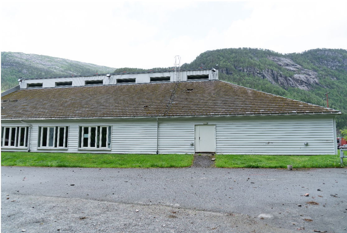
Figur 3-7. Mange små steinsplinter er spredt utover. Det er enkelte små skader på husvegg og to vinduer.
