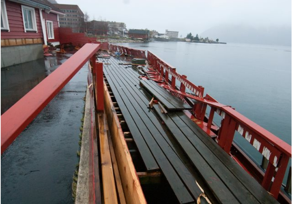
Stormfloen under Dagmar november 2011 gjorde store skader, her fra Leikanger. Foto: Knut Strøm.
