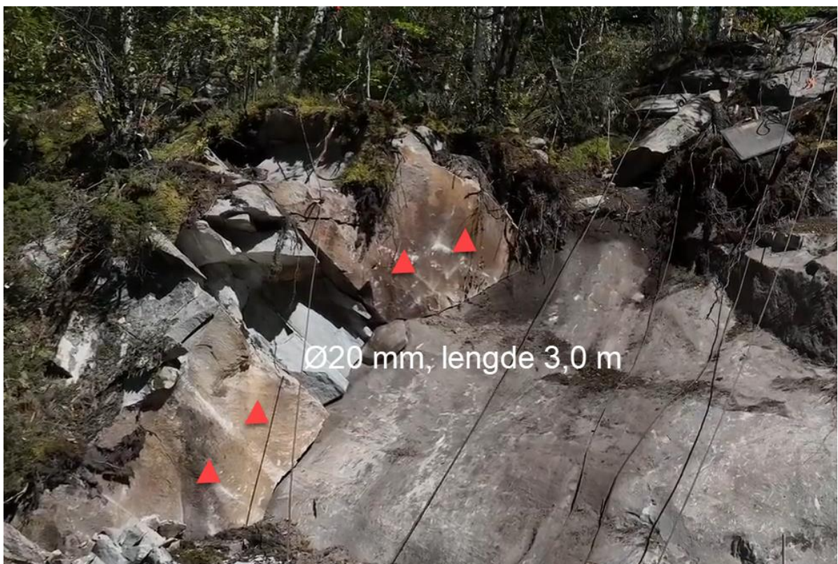
Bilde 3. Det installeres 3,0 m lange Ø20 mm endeforankrede bolter på skrå inn i glideplanet under.
