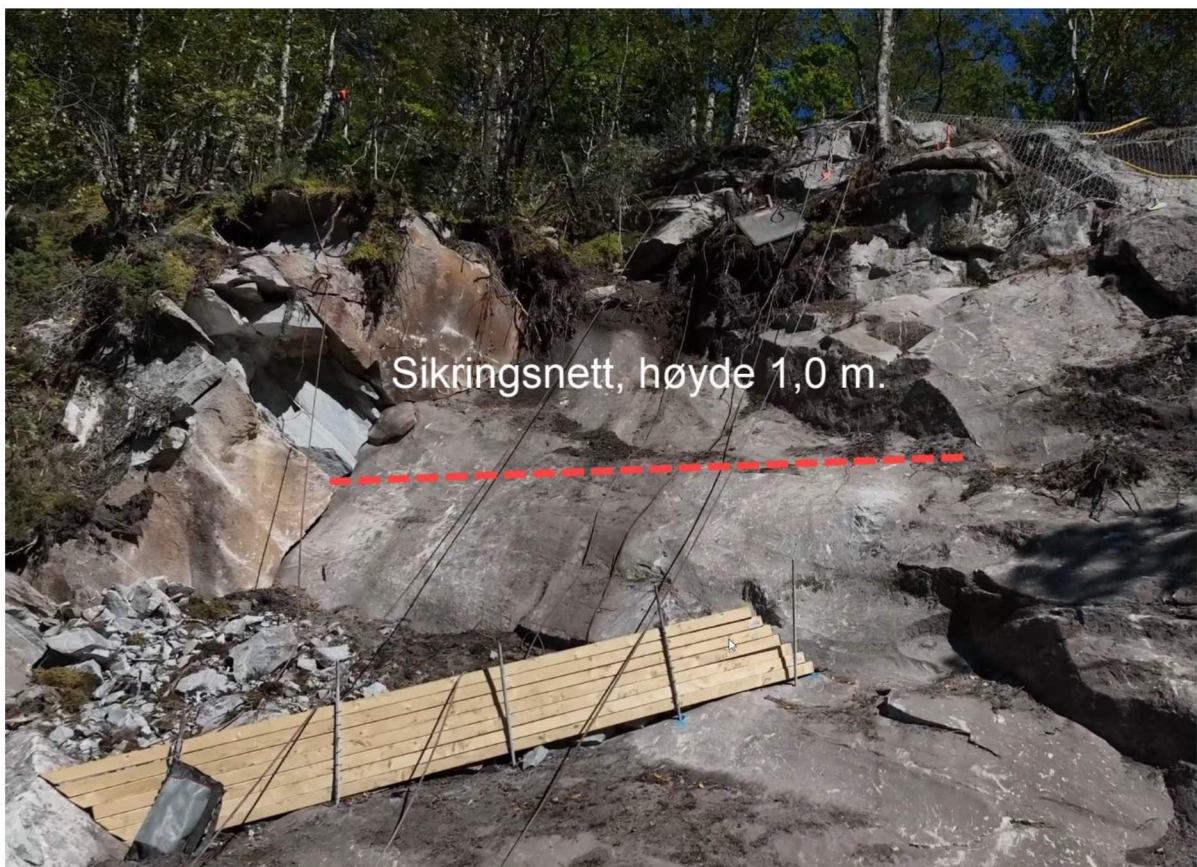
Bilde 1. Sikringsnett med høyde 1,0 m installeres i skråningen for å hindre nedfall av steinfragmenter på vegbanen.
