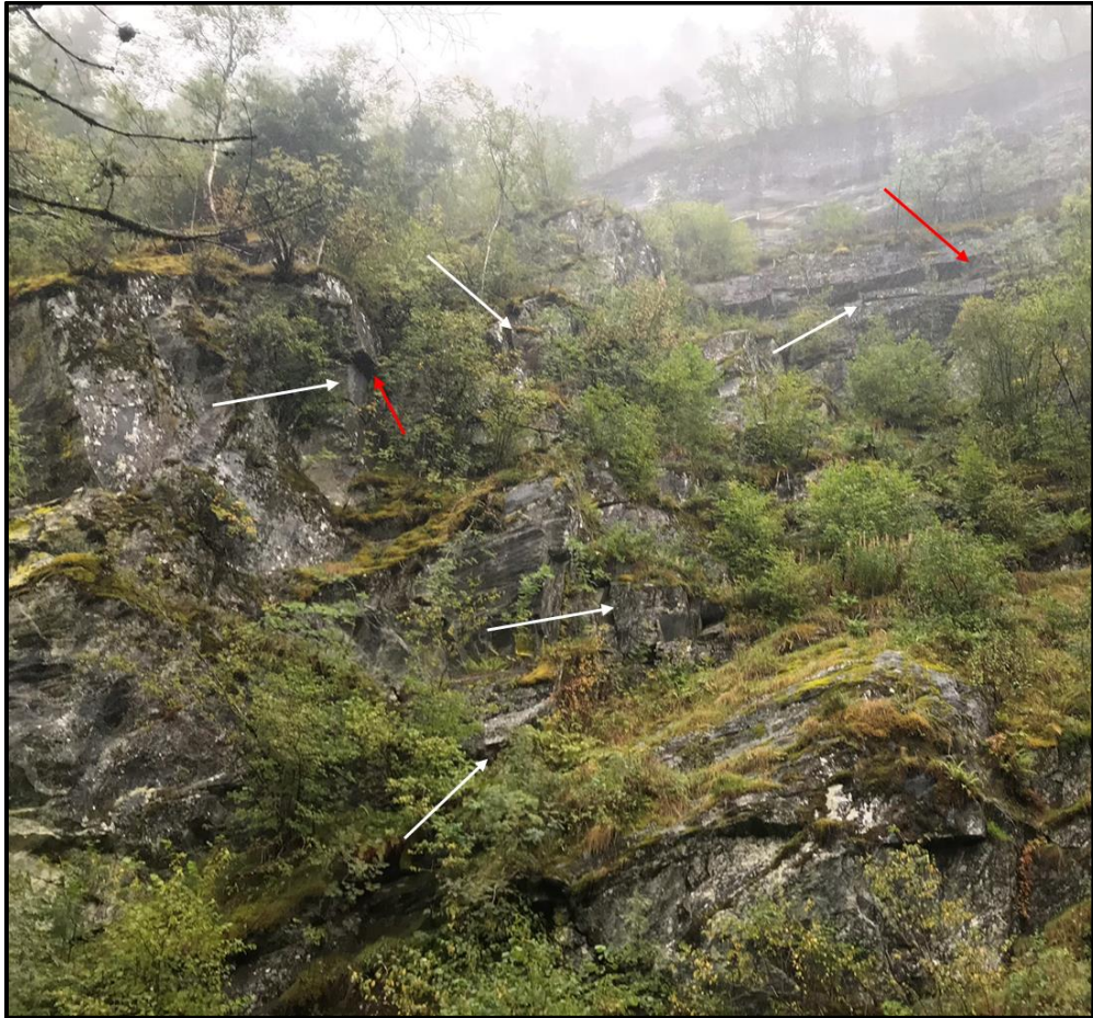
Figur 9. Hvite piler markerer løse blokker i fjellsiden og røde piler markerer områder med spor etter blokker som har løsnet. Bildet er tatt fra nederste høydemeter av fjellsiden mot Mo sentrum.
