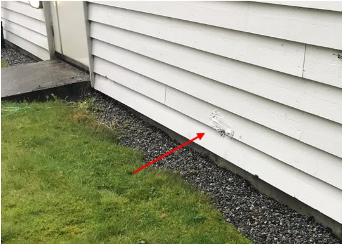
Figur 16. Skade på Mo kulturhus etter steinsprang.
