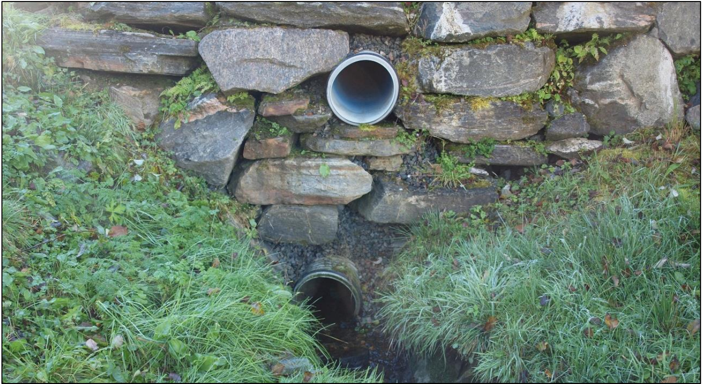
Fig 7. Dreneringsrør i nord på nåværende lagringsflate. Utløp mot eksisterende bekk gjennom området.
