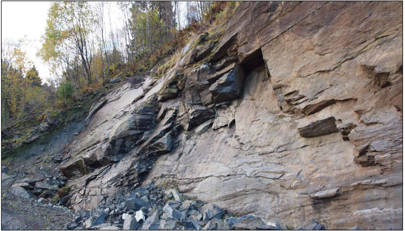
Fig 11. Ustabile blokker i sørlige del av skrent (fig 10).
