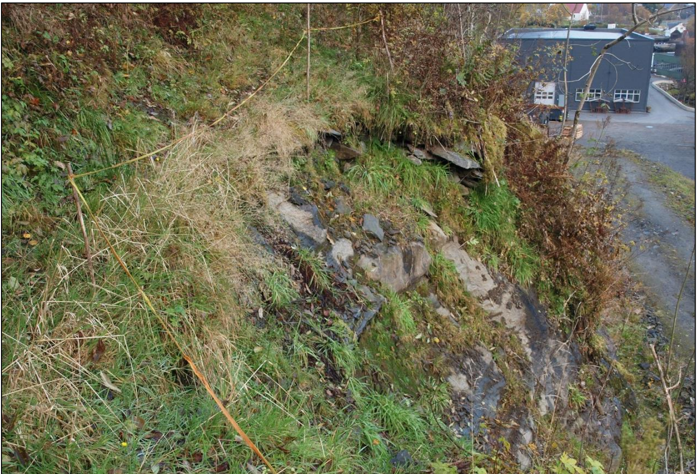
Fig 16. Gangvei mot topp av skrent har rast ut.
