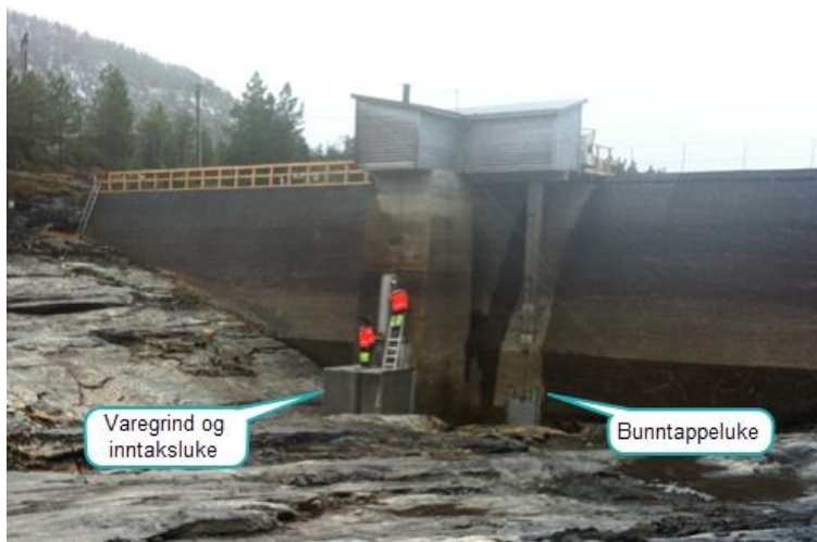
Bilde 3-1. Inntaket til Osvatn kraftverk, og bunntappeluke som ble skiftet ut i 2012. Foto: BKK
