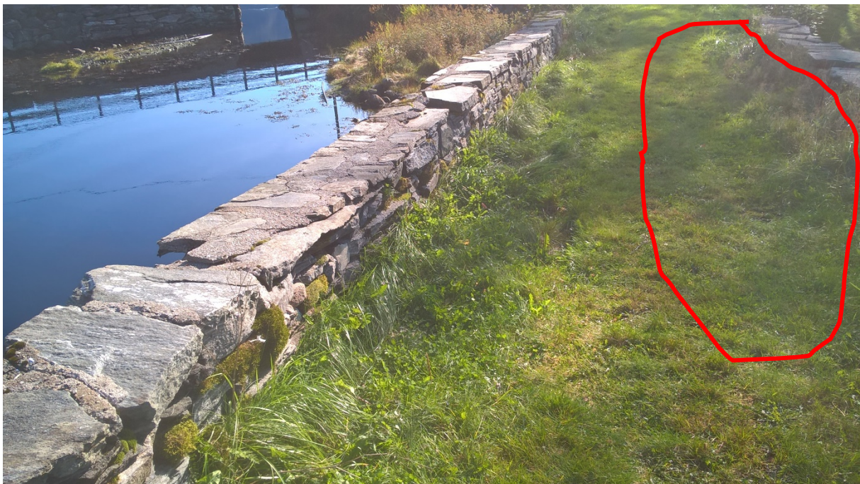
Figur 2 Innringa med raudt er eit område i overflata av brua med eit tydeleg søkk, ein klar indikasjon på skade under.
