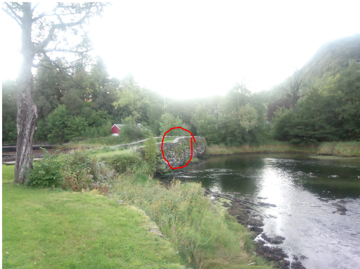
Figur 1 Det skadde området er på oversida av brua (oppstraums). Det tydelege søkker ein kan avlesa på parapetet (det oppmura rekkverket) avspeglar ei setning som går heile vegen nedover mot fundamentet og innover i murverket.
