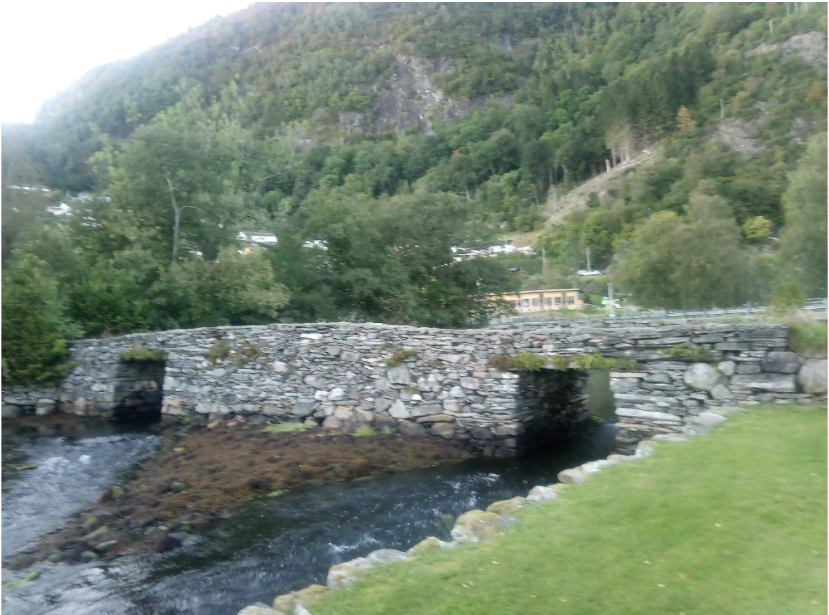
Figur 6 Verken nedstrøms eller i dei to vassfara har ein konstatert skade på murverket.
