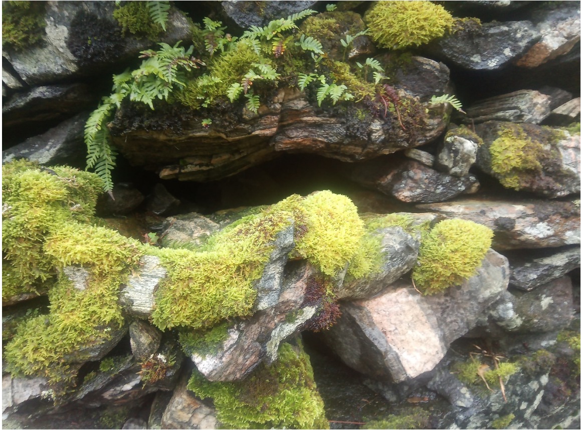
Figur 3 Frå dei nedre delane av murverket: steinar på veg ut.
