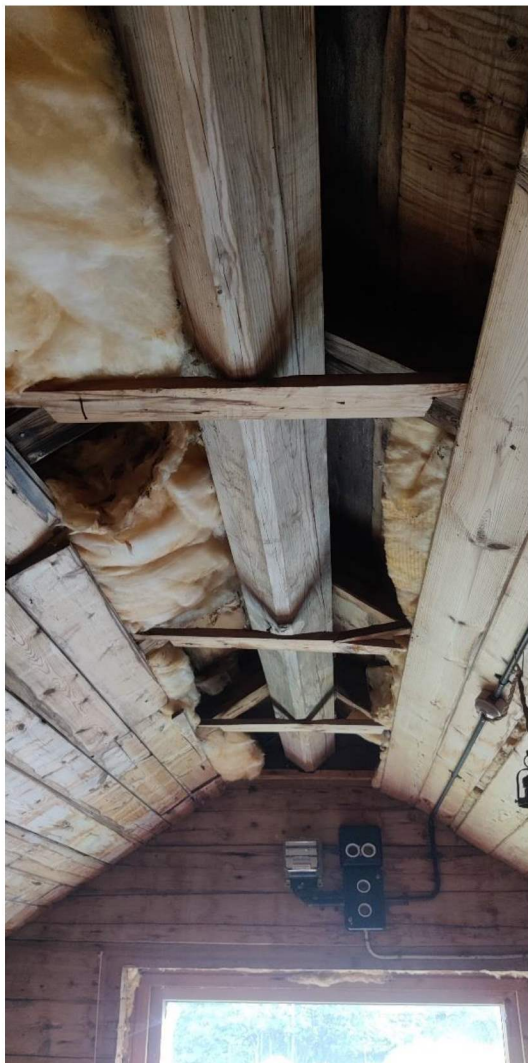
Kledning og isolasjon er fjerna rundt takbjelken.
