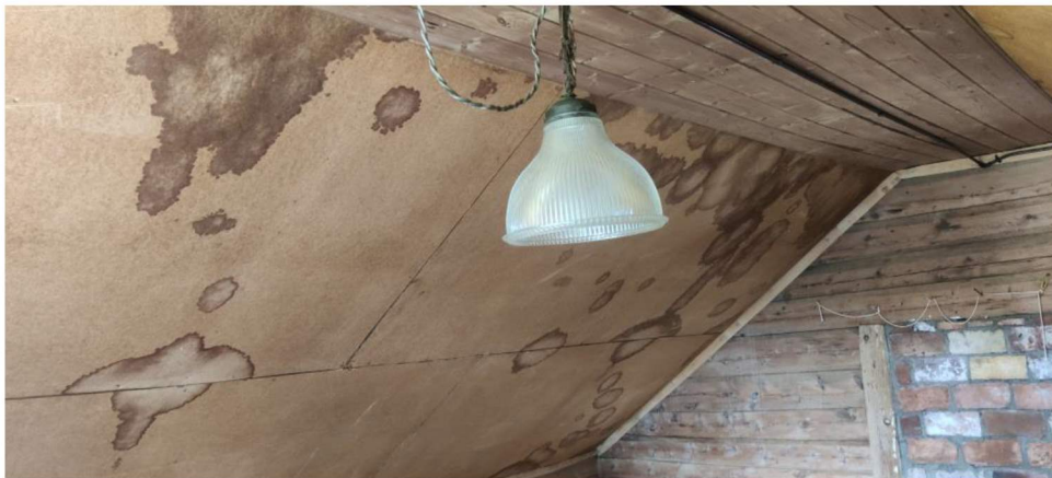
Fuktskadar på innerkledning på loft.
