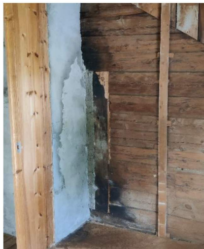
Fuktskade på loft
