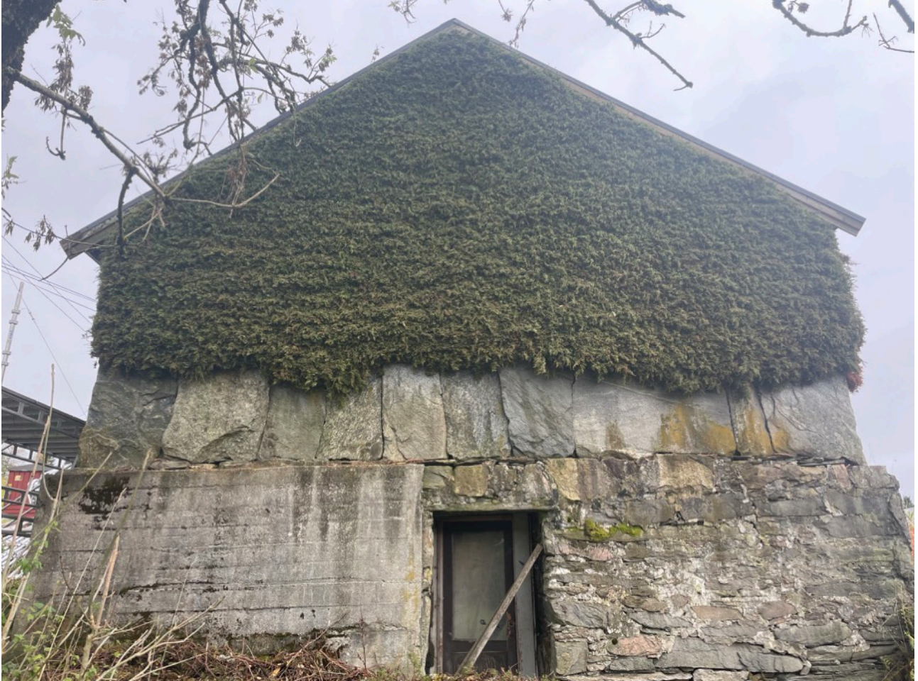
Gavlveggen med gammel og ny kledning.
