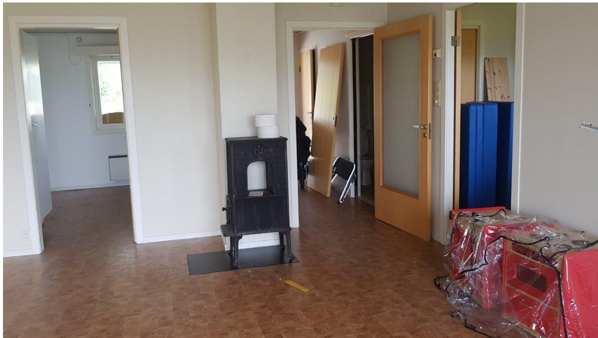
Bilde 4 : Alle innvendige gulvflater består av ftalatholdig-gulvbelegg. Gulvbelegg må deklarerer og leveres til godkjent mottak for farlig avfall
