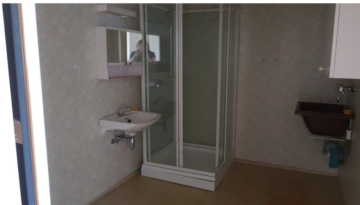
Bilde 3 : PCP-holdige plater på alle bad/toalett. OBS, disse finnes også malt i bygningsmassen, og må ikke forveksles med ordinært treverk/gips
