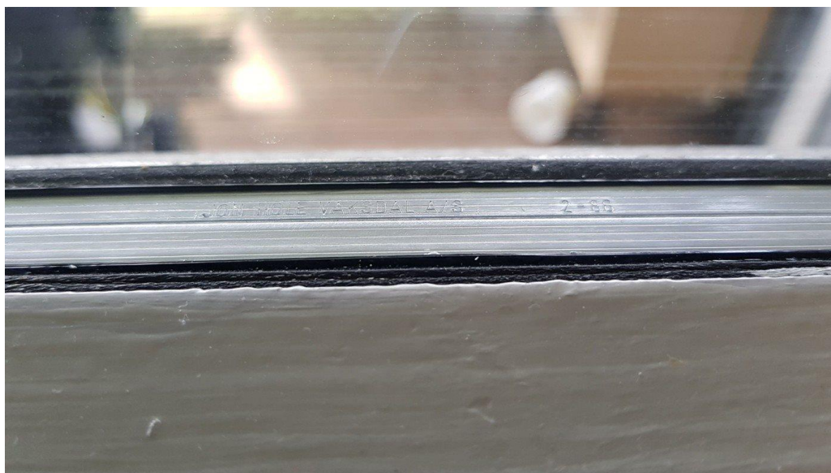
Bilde 5 : Isolerglassruter, her datert 86, må deklarerer og leveres til godkjent mottak for farlig avfall som klorparafinholdig farlig avfall
