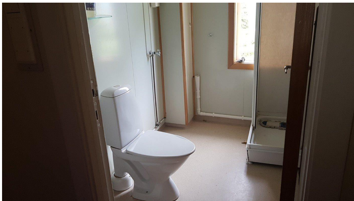
Bilde 10: Toalett med PCP-holdige plater på vegger. PCP-holdige plater må deklarerer og leveres som farlig avfall til godkjent mottak
