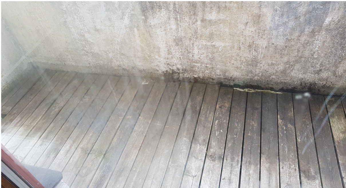
Bilde 7: Terrasse i CCA-impregnert treverk, 2. etg
