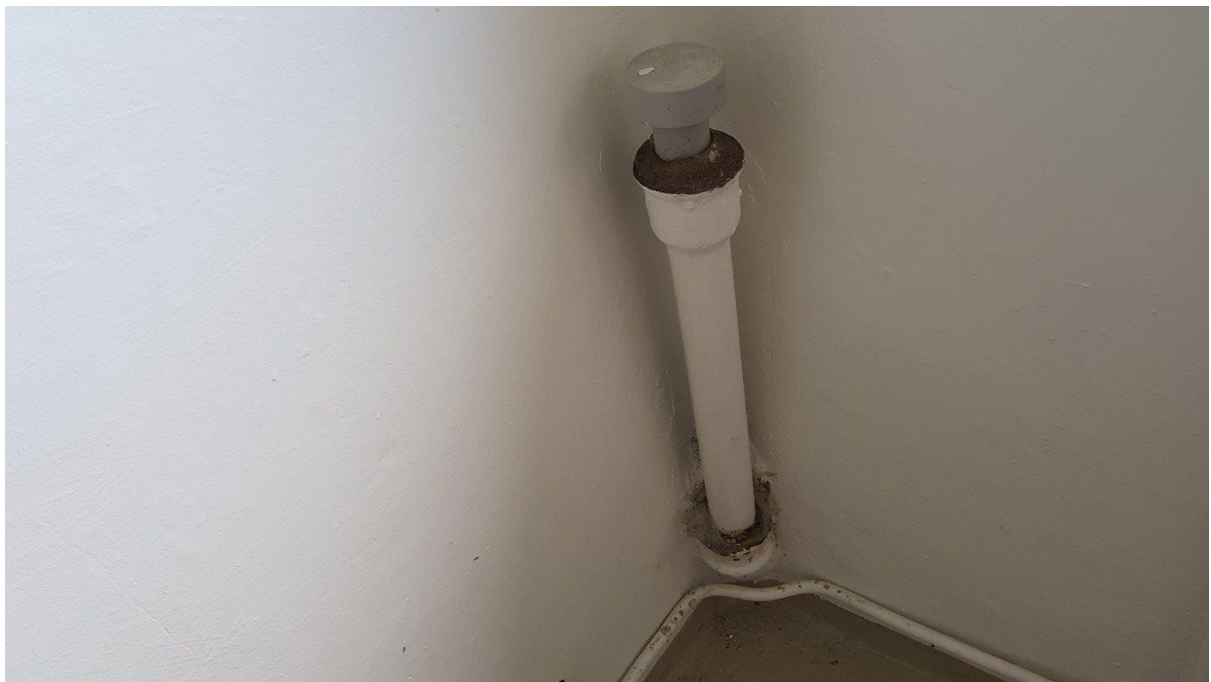
Bilde 5: Soilrør er observert i bygningsmassen. Soilrør inneholder bly i skjøtene som må sorteres ut som egen fraksjon
