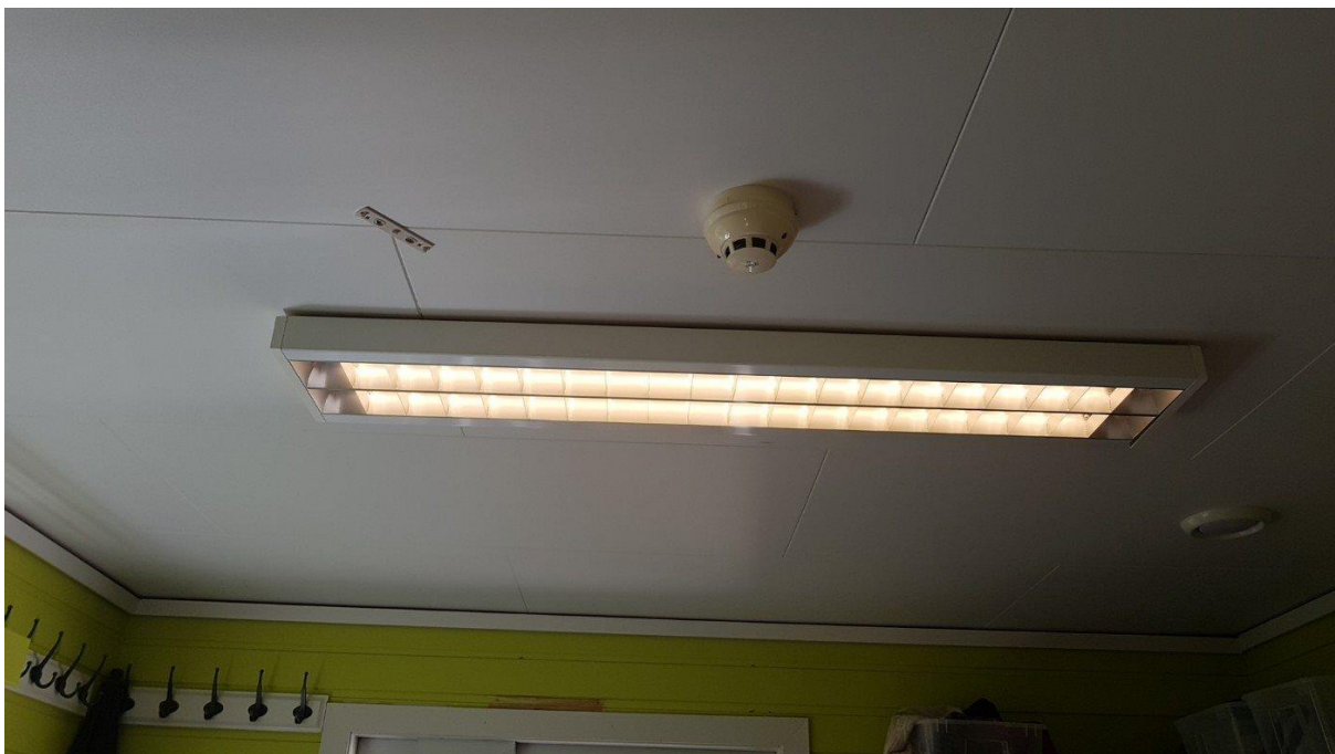
Bilde 5: Lysstoffrør i takarmeturer
