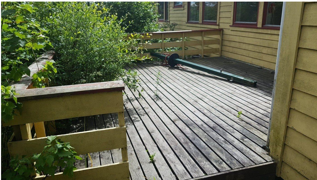
Bilde 2: Terrasse på baksiden av bygget av CCA-impregnert treverk. Må deklarerer og leveres til godkjent mottak for farlig avfall
