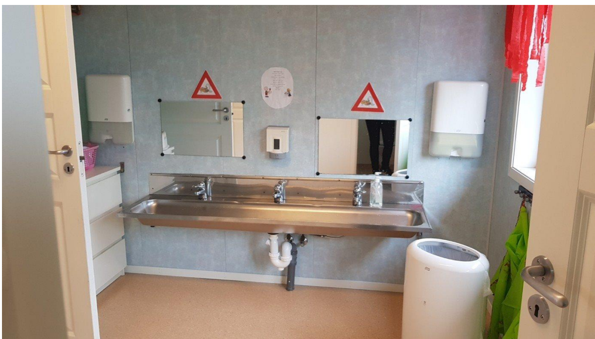
Bilde 3: PCP-holdige veggplater på bad/toalett
