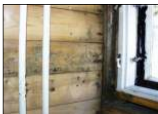
Muggsoppskader som følge av oppfukning etter brannsløkking.
