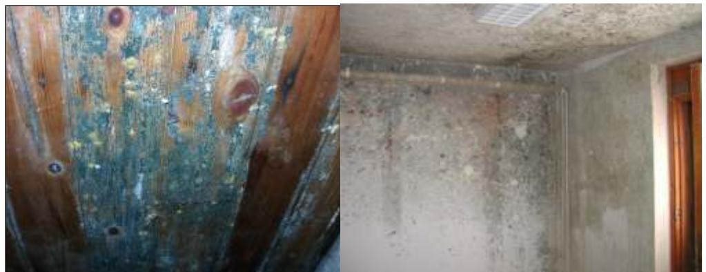
Muggvekst etter vannlekkasje.
