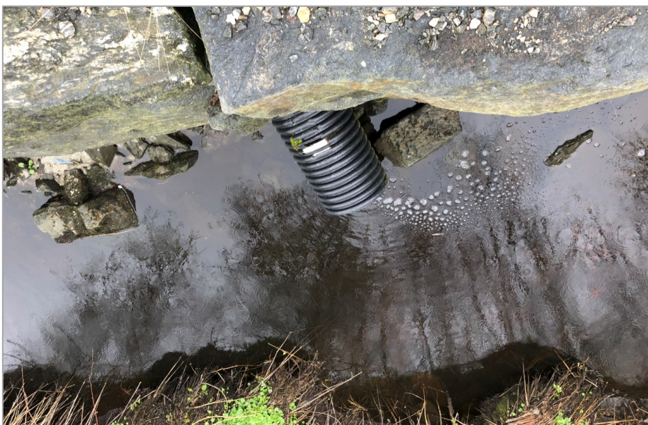
Figur 24. Eit av fleire røyr med utslepp av vatn frå næringsområdet til bekken.
