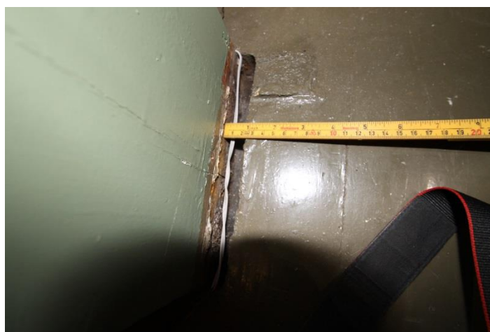
Figur 12. Sprekk på galleri
