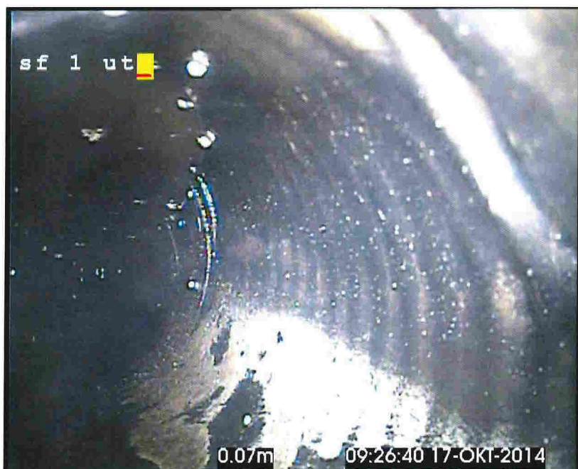
Foto: SF 1_Ut_1_2_A.jpg 0,1m, Deformasjonen er 5 % eller mindre av rørdimensjonen, fra 11 til 03 Kl., Punkt deformasjon
