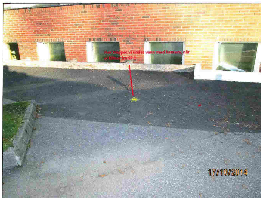
Foto: Trase fra SF 1.JPG 0,1m, Deformasjonen er 5 % eller mindre av rørdimensjonen, fra 11 til 03 Kl., Punkt deformasjon
