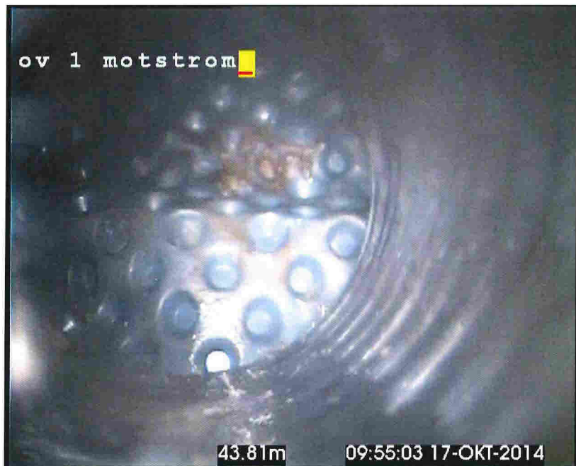
Foto: Motstrøm_OV 1_2_8_A.jpg 44m, Inspeksjon fullført trolig i husvegg
