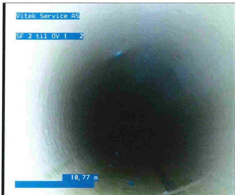
Foto: 3_SI_WorkNumber_S_Sectionname_SF 2OV 105122014131539_A.jpg 10,77m, Deformasjonen er 5 % eller mindre av rørdimensjonen, 11 Kl., Punkt deformasjon
