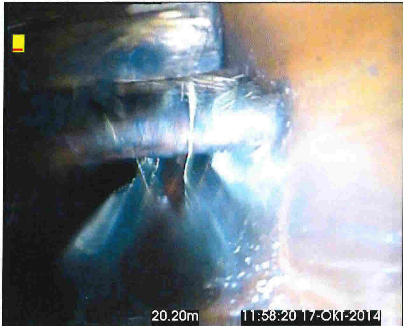
Foto: SF 2_OV 1_1_3_A.jpg 20,2m, Inspeksjon avbrutt Hindring, ved gren fra SF 1
