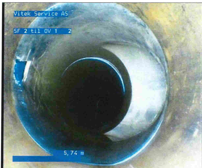
Foto: 3_SI_WorkNumber_S_Sectionname_SF 2OV 105122014131247_A.jpg 5,74m, Sprukket rør, Rørbiter har løsnet eller mangler/teglstein mangler fra sin opprinnlige posisjon, 09 Kl., Kompleks
