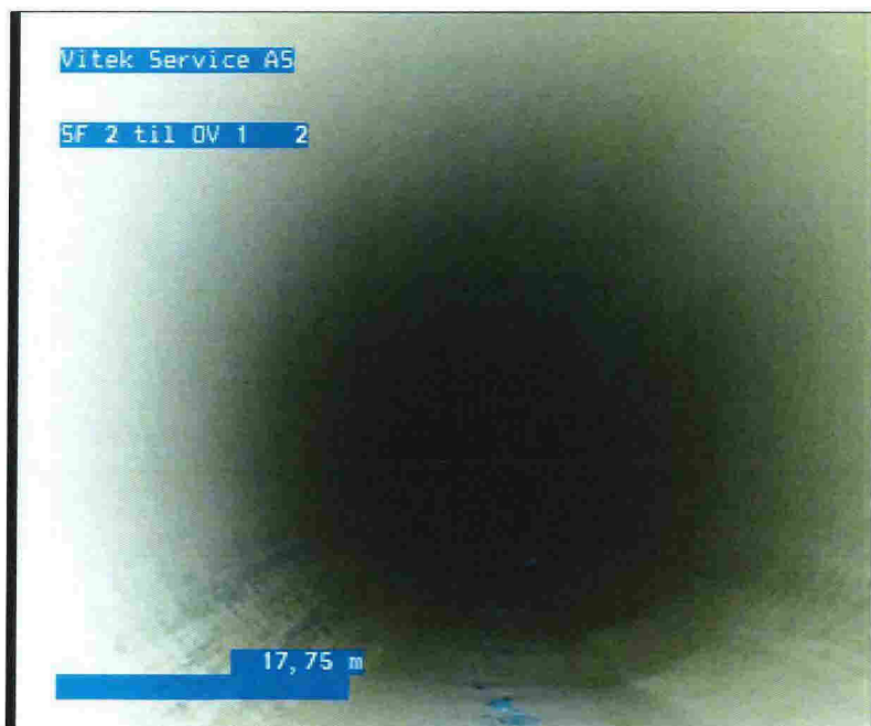
Foto: 3_SI_WorkNumber_S_Sectionname_SF 2OV 105122014131712_A.jpg 17,75m, Deformasjonen er 5 % eller mindre av rørdimensjonen, fra 05 til 06 Kl., Punkt deformasjon
