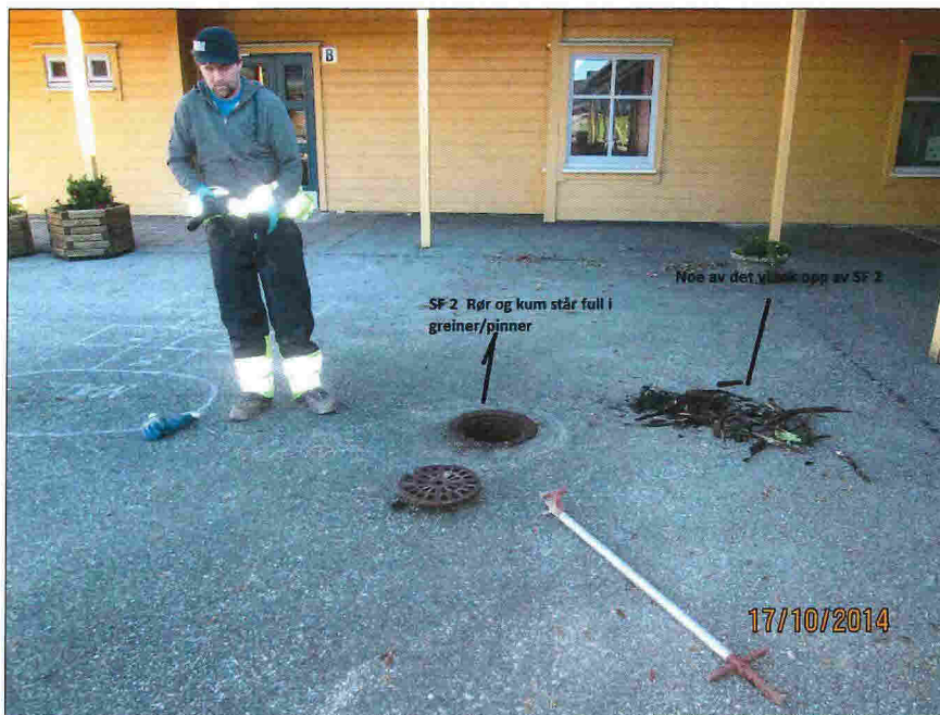
Foto: Oversikt SF 2.JPG 18,05m, Tilkopling Prefabrikkert grenrør. 03 Kl.
