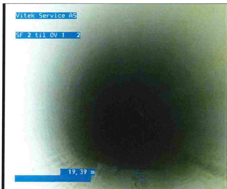
Foto: 3_SI_WorkNumber_S_Sectionname_SF 2OV 105122014131743_A.jpg 19,39m, Deformasjonen er 5 % eller mindre av rørdimensjonen, fra 05 til 07 Kl., Punkt deformasjon
