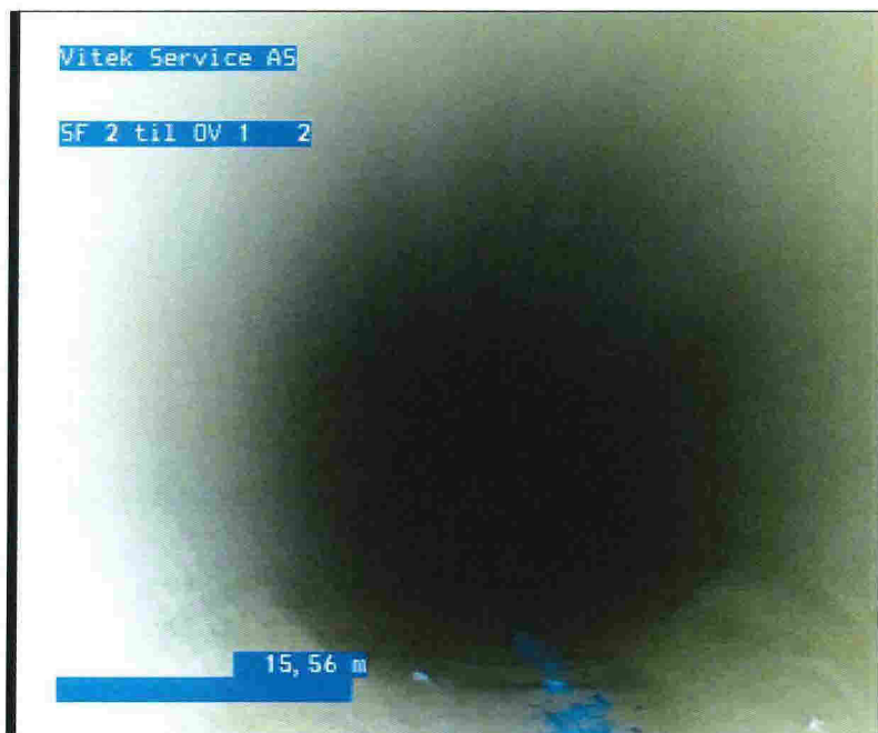
Foto: 3_SI_WorkNumber_S_Sectionname_SF 2OV 105122014131638_A.jpg 15,56m, Deformasjonen er 5 % eller mindre av rørdimensjonen, fra 05 til 07 Kl., Punkt deformasjon
