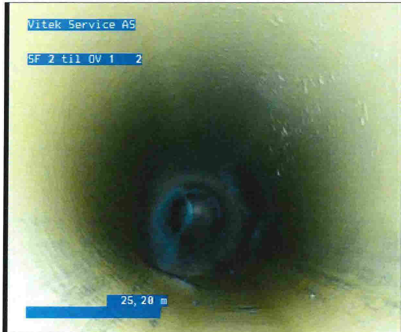
Foto: 3_SI_WorkNumber_S_Sectionname_SF 2OV 105122014131842_A.jpg 25,2m, Deformasjonen er mellom 5 - 15 % av rørdimensjonen, fra 06 til 08 Kl., Punkt deformasjon
