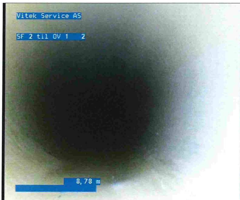
Foto: 3_SI_WorkNumber_S_Sectionname_SF 2OV 105122014131452_A.jpg 8,67m, Deformasjonen er 5 % eller mindre av rørdimensjonen, 05 Kl., Punkt deformasjon
