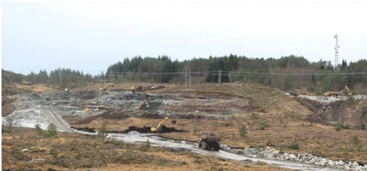
Status for arbeider på Lindås trafostasjon februar 2015
