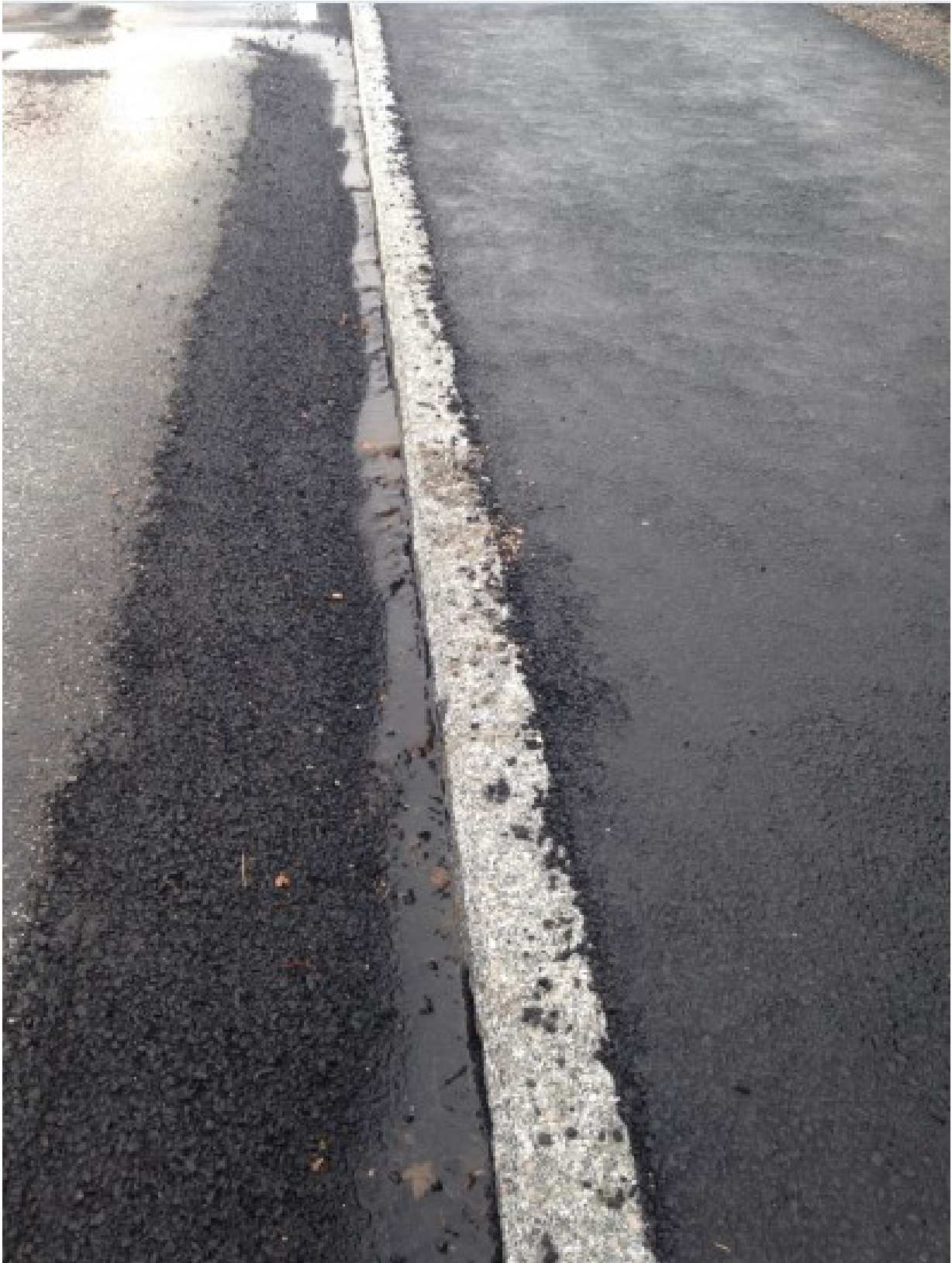
Grus «kommer opp» mellom asfalt og kantstein.
