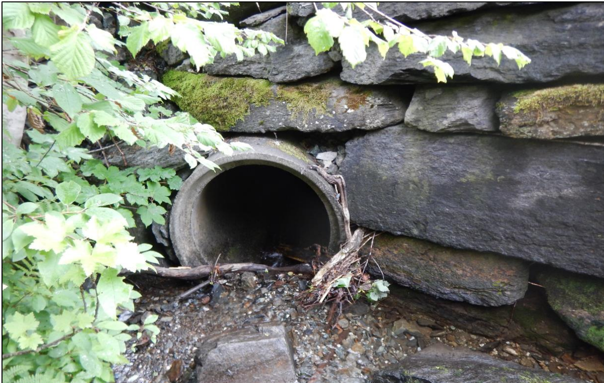
Figur 12: Bilde av kultvertinntak ved punkt 4.
