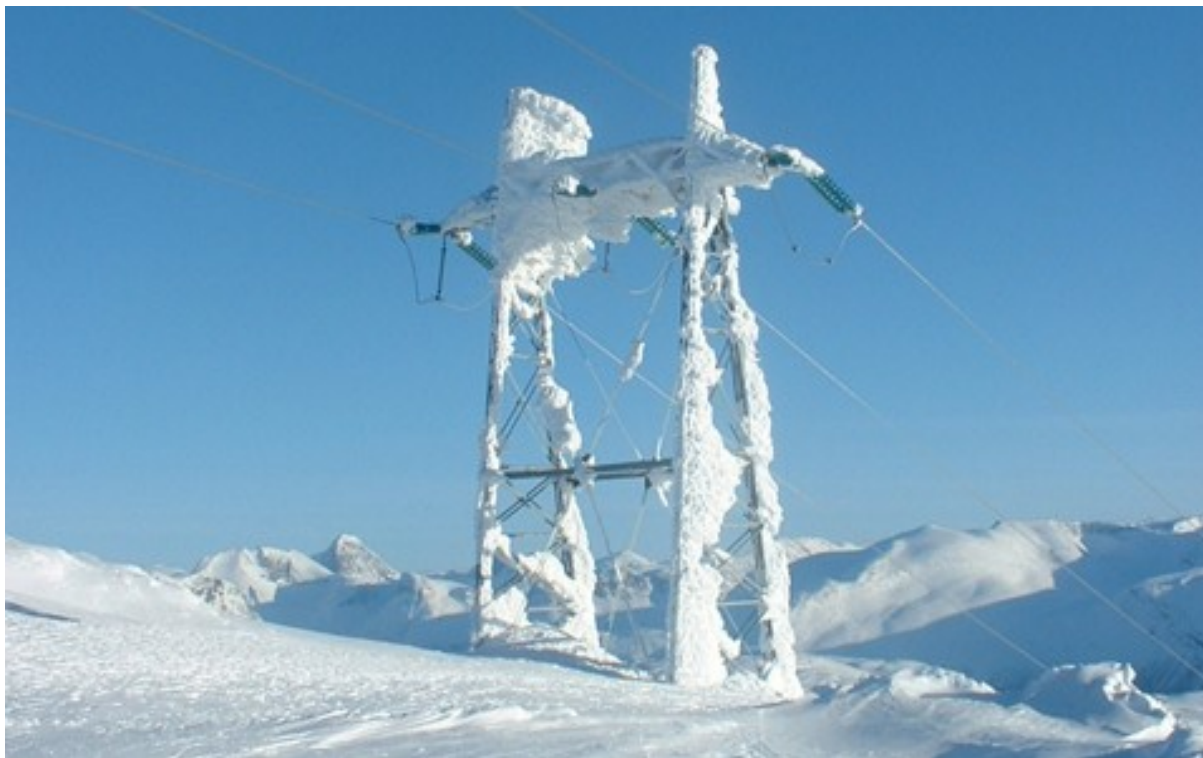
300 kV høgspenningsmast i høgfjellet om vinteren. Foto frå LVK sine nettsider.
