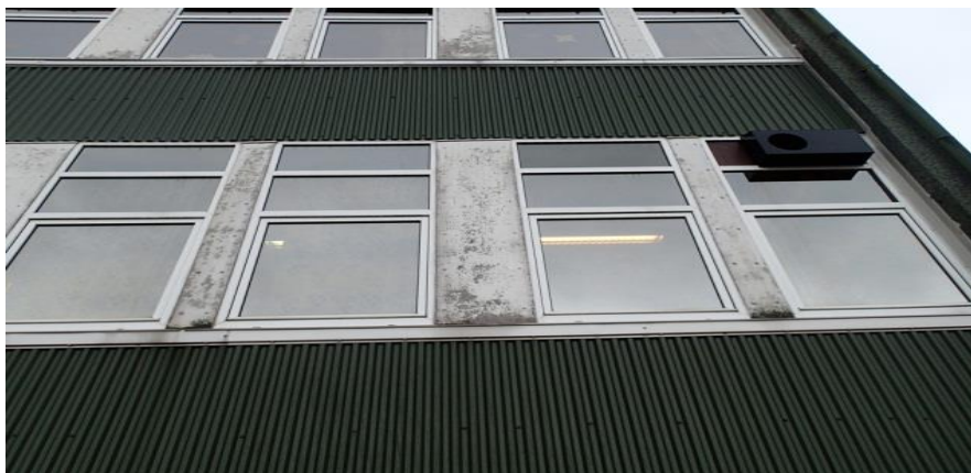
Vaksdal skule, ytterplater av asbest som er slitt.
