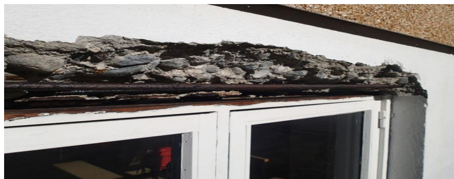
Skade på utvendig vindu, Dale barne- og ungdomsskule
