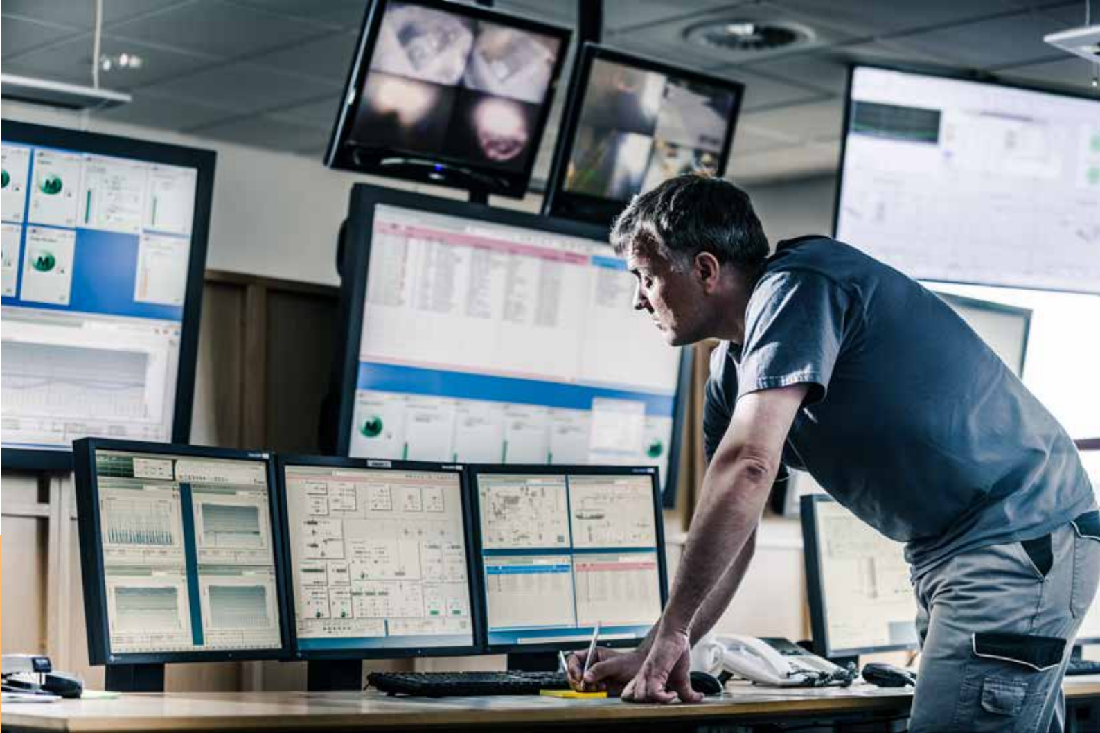
Fra kontrollrommet på energianlegget. Herfra styres både forbrenningsprosessen og fjernvarmenettet.
