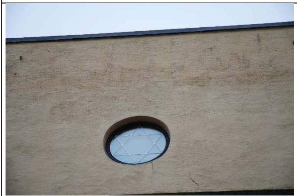
Bilde nr. 234.06 Utvendige vinduer, dører, porter Rundt vindu av nyere dato. Sprossene er limt på innsiden av glass. Dette er ikke i henhold til antikvariske prinsipper.
