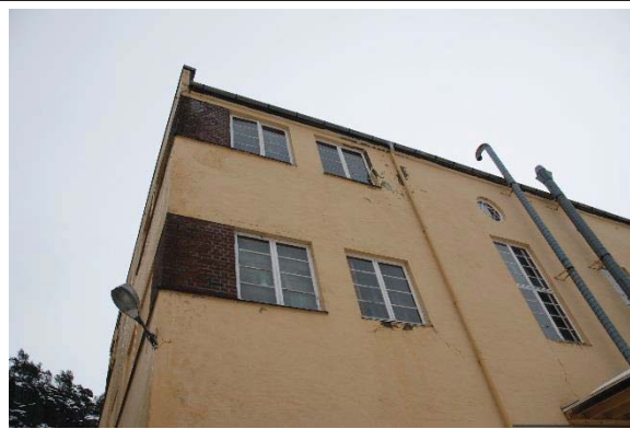
Bilde nr. 234.03 Utvendige vinduer, dører, porter Opprinnelige vinduer på fasade mot vest.
