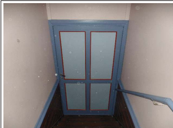
Bilde nr. 244.04 Innvendige vinduer, dører , foldevegger Dør i trapp opp til galleri. Denne døren er opprinnelig, men malt i nye farger.
