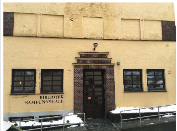
Bilde nr. 234.04 Utvendige vinduer, dører, porter Fasade mot nord. Vinduer blendet igjen.
