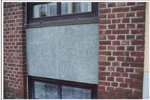
Bilde nr. 230.02 Yttervegger Detalj materiale mellom vinduer. På opprinnelig tegninger er det beskrevet skifer i disse feltene.
