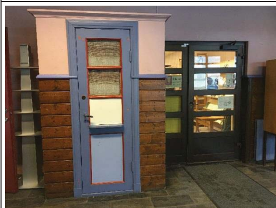
Bilde nr. 244.02 Innvendige vinduer, dører, foldevegger 1. etg :Foaje. bilettkiosk. Opprinnelig dør og utforming av listverk, malt i andre farger enn opprinnelig.
