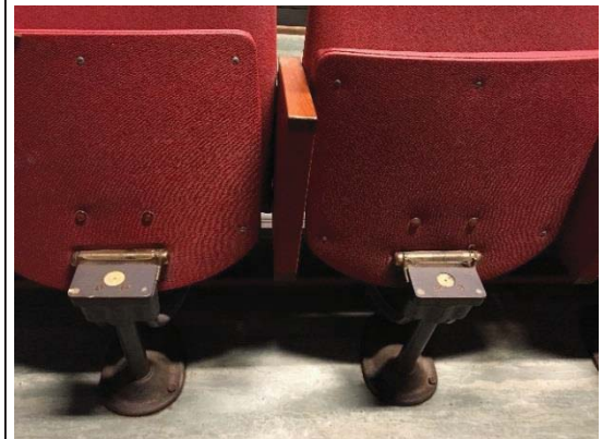
Bilde nr. 285. 02 Tribuner og amfier Detalj. Klappstoler er muligens montert på 1960-tallet.
