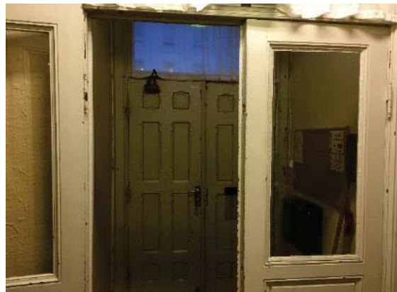
Bilde nr. 15. 1. etg : inngangsdør fra opprinnelig byggeår. Lister rundt dør er også opprinnelige.
