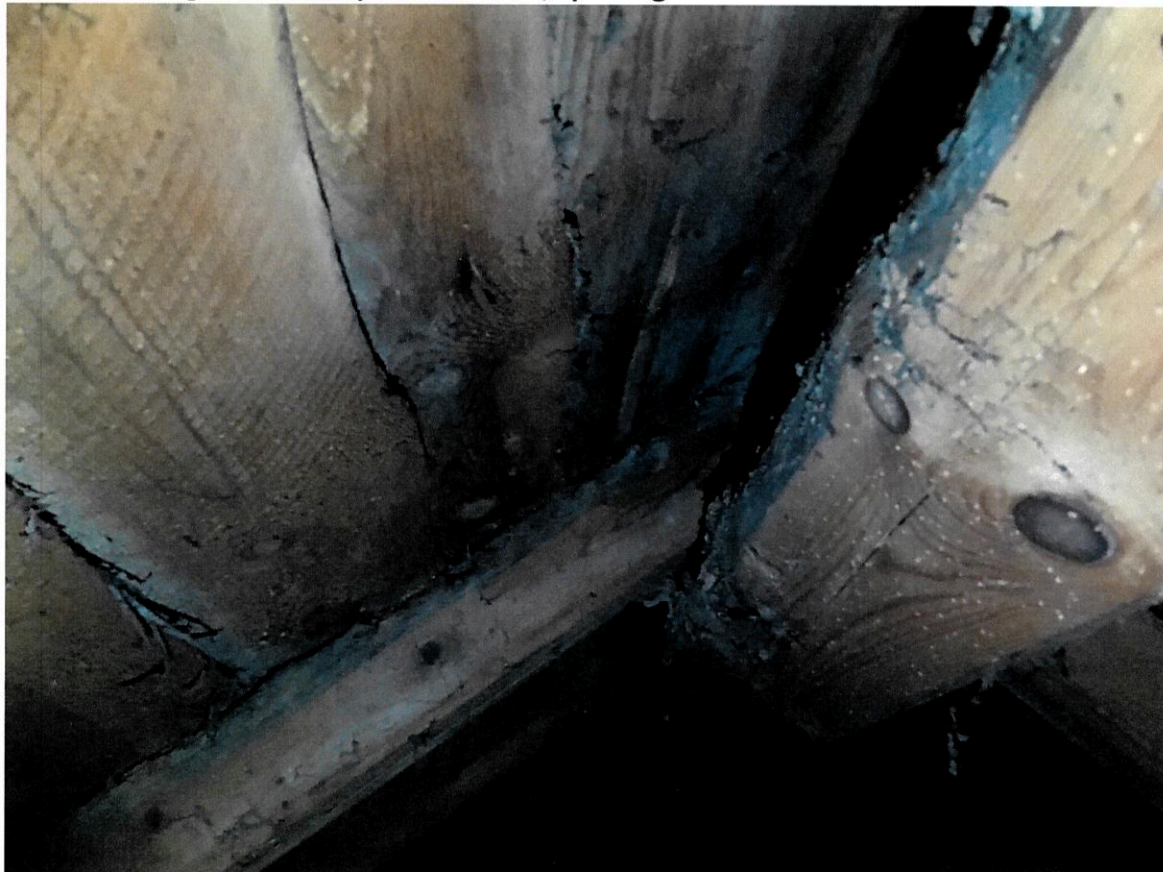
Bilde 1: Mit og fuktskadar på både sutak, sperr og rammeverk.
