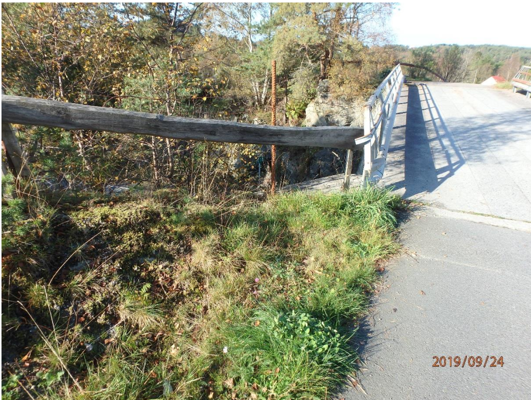
Bilde nr. 6 Rekkverksovergang østre landkar sørside.
