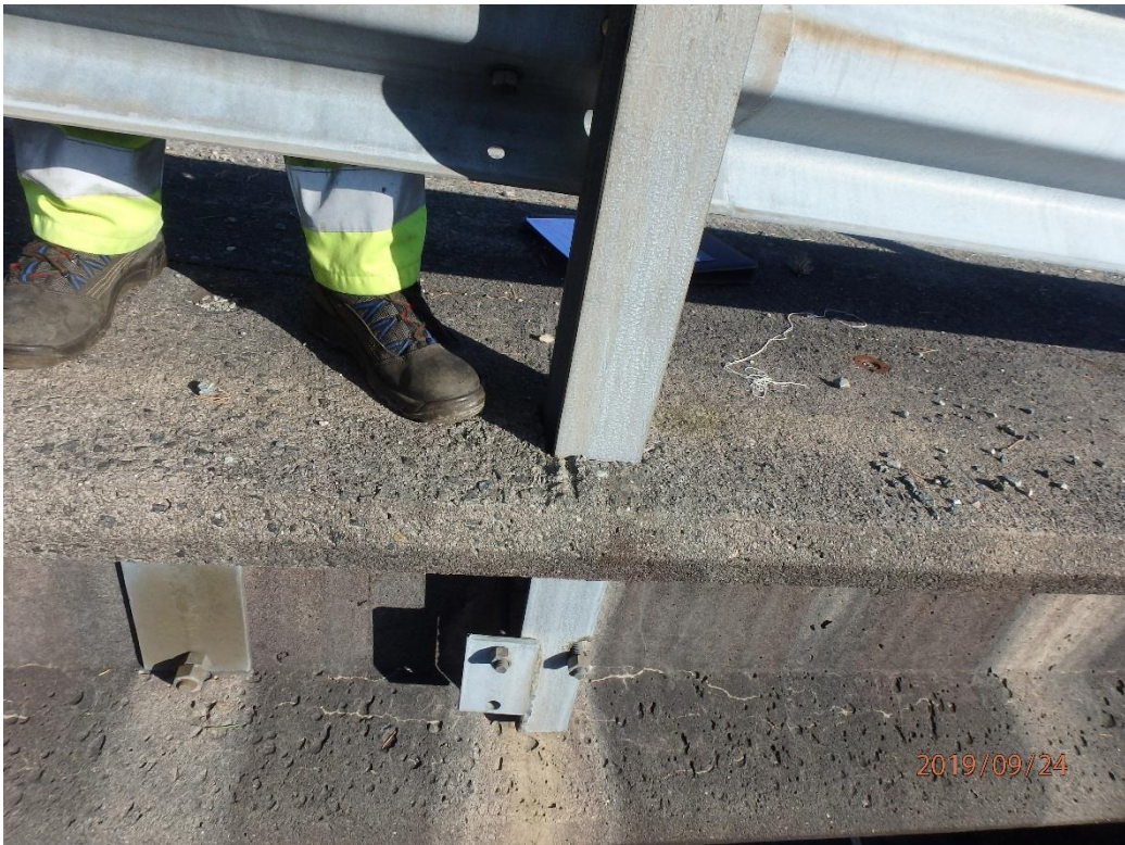
Bilde nr. 13 Løs klempate i feste for rekkverksstender midt på sørside bru.
