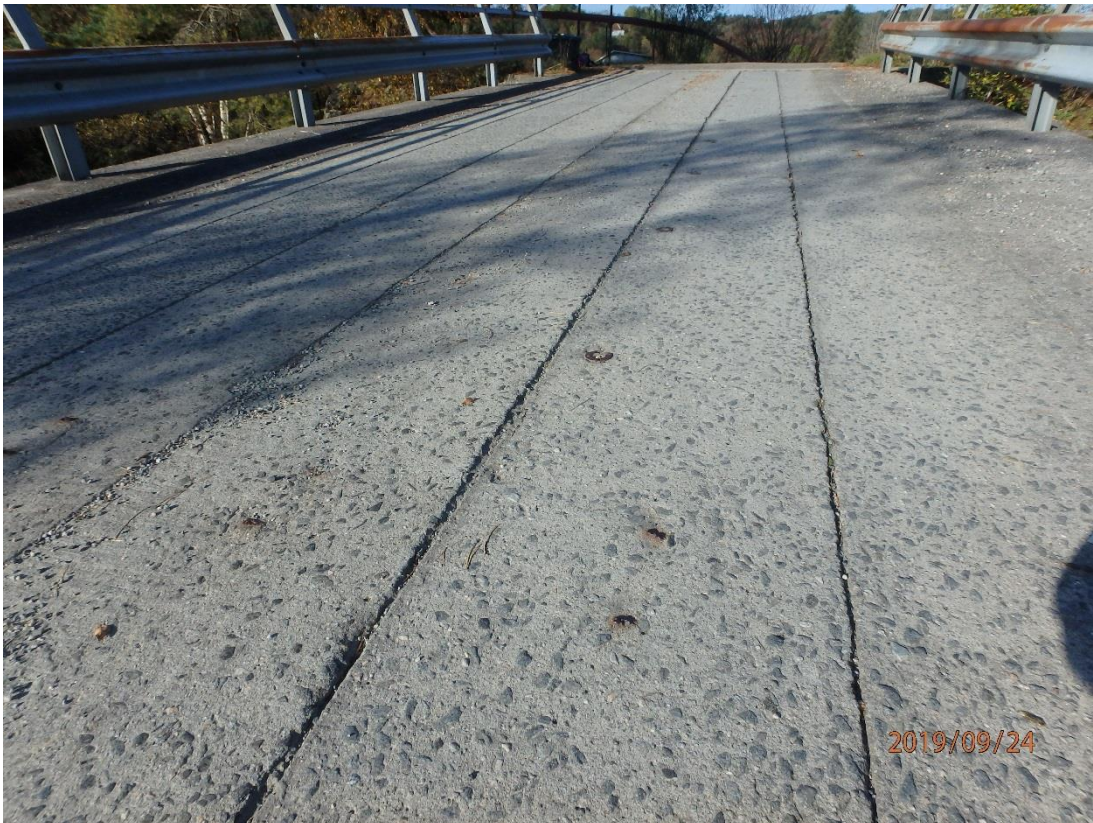
Bilde nr. 8 Dekke oversikt lett slitasje, ingen skader av betydning i flenskanter bjelker.
