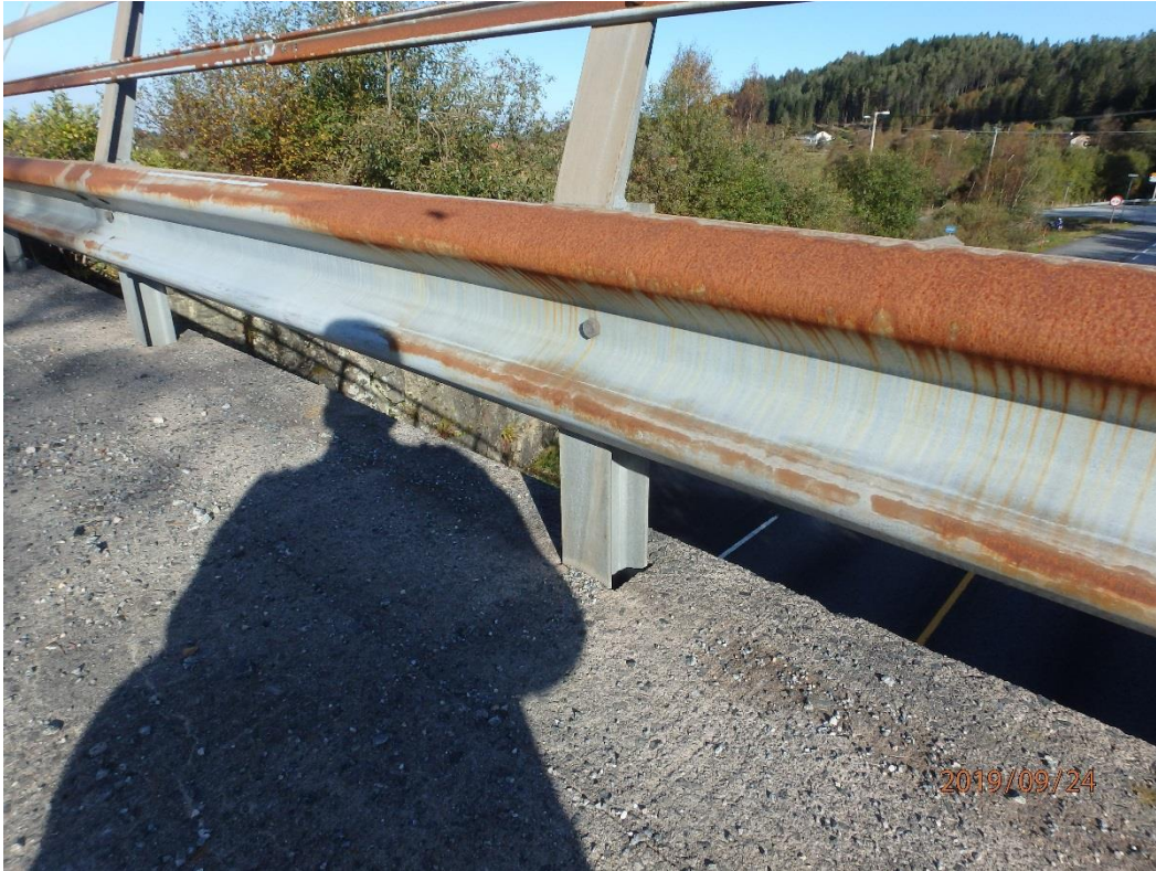
Bilde nr. 14 Lett overflatrust i rekkverksprofiler, varmgalvanisering er oksydert bort. Skjøt i sekundærprofil over guardrailskinne er ikke koblet.
