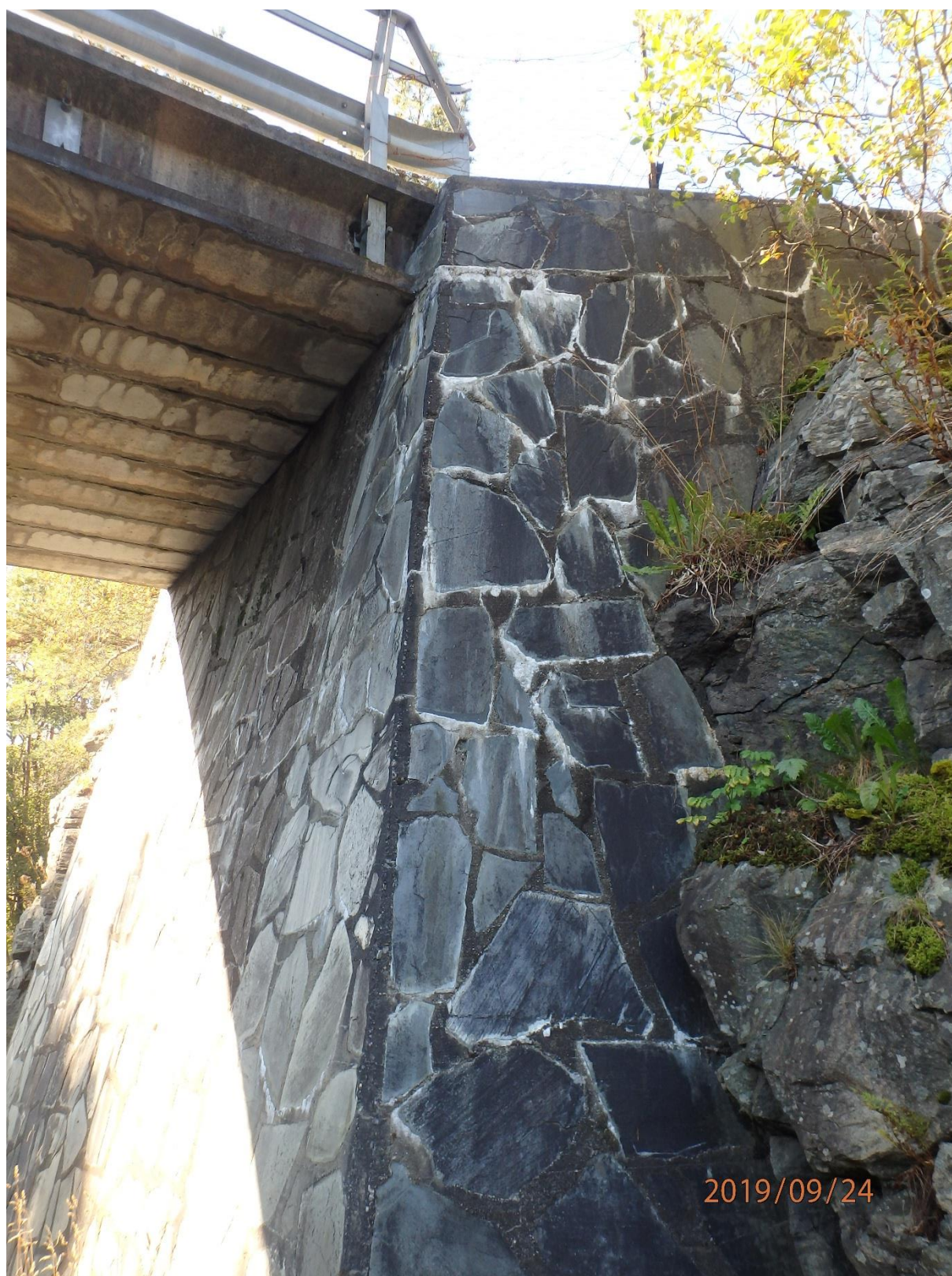
Bilde nr. 10 Nordside vestre landkar, kalkutfelling pga. vanngjennomslag fra oppleggshylle.
