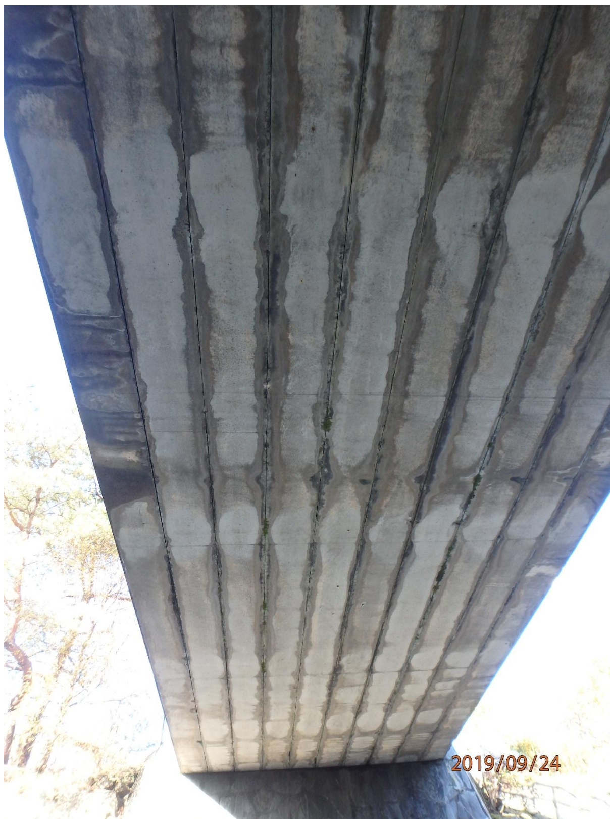
Bilde nr. 9 Underkant bru, vanngjennomgang i fuger mellom bjelker, ingen indikasjon på skader i form av armeringskorrosjon.
