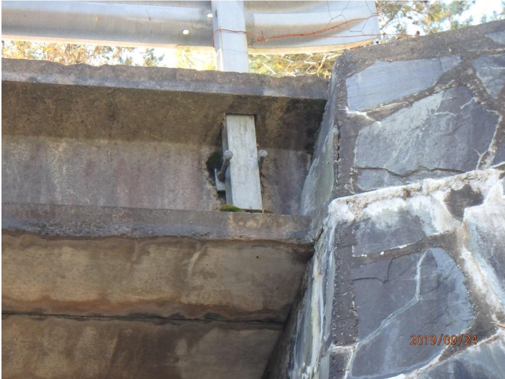
Bilde nr. 12 Klempate mangler i feste for rekkverksstender vestre ende nordside.
