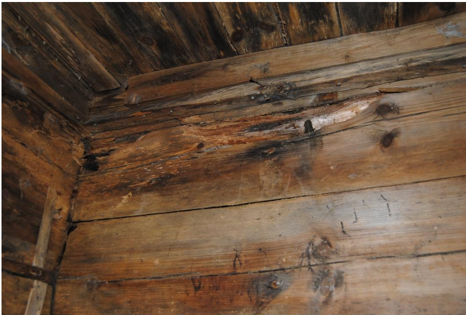
Råte- og soppdannelse høyt oppe på veggen mot sør/øst.
