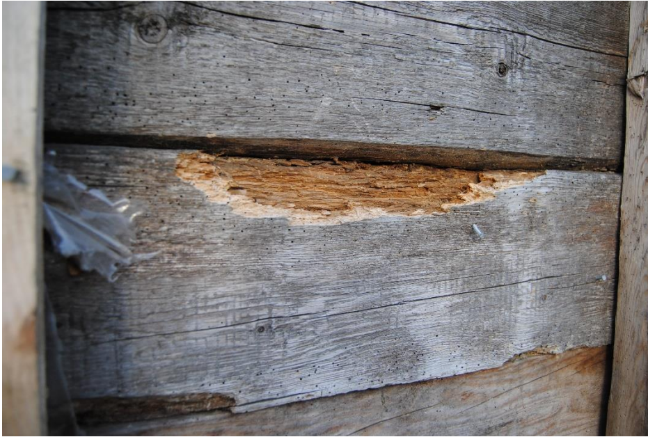
Omfattende mitangrep i yttervegg mot sør/øst.
