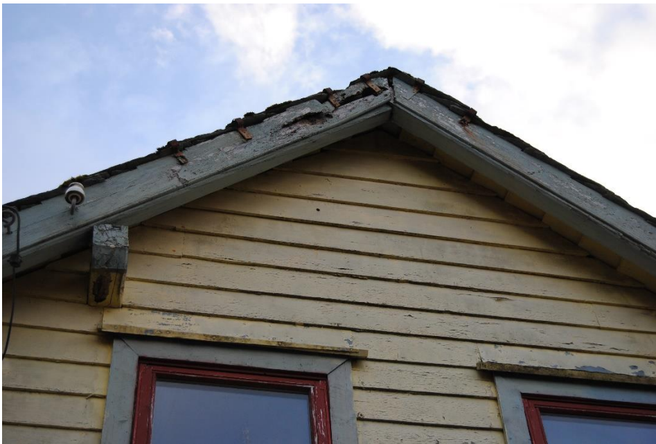
Råteskader i vindskibordene tyder på at det også er råteskader i sperret som ligger bak.
