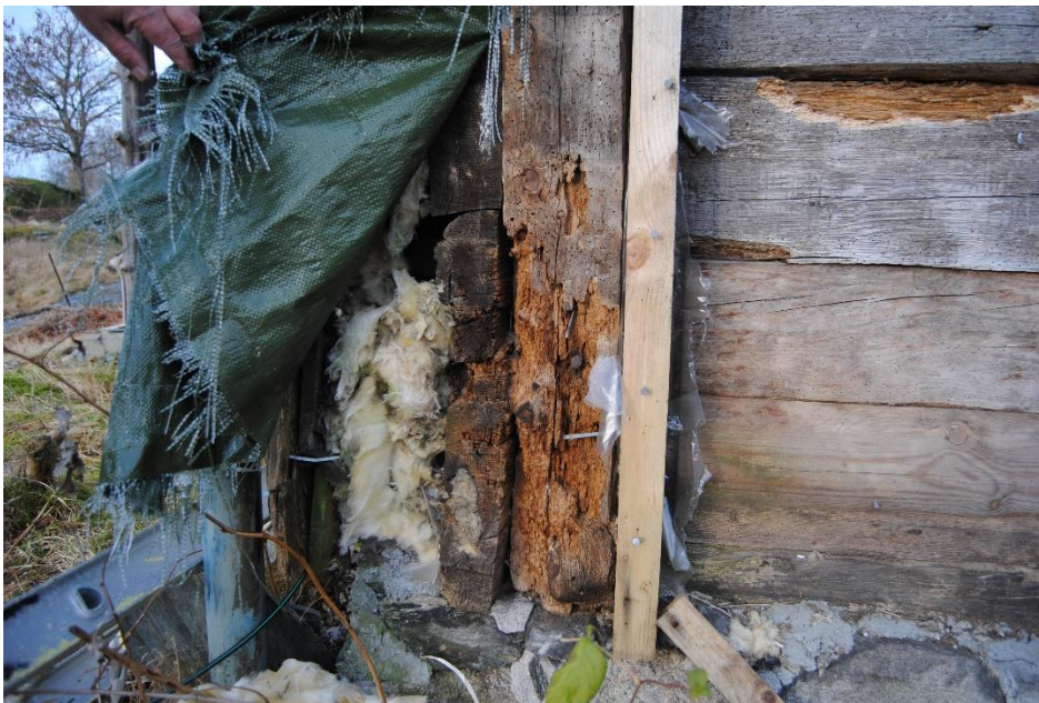
Hjørnestokk med betydelige råteskader.
