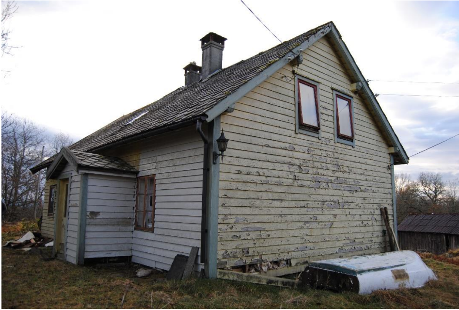
Grunnet råteskader i veggene er kledningsbordene i ferd med å ramle ned.
