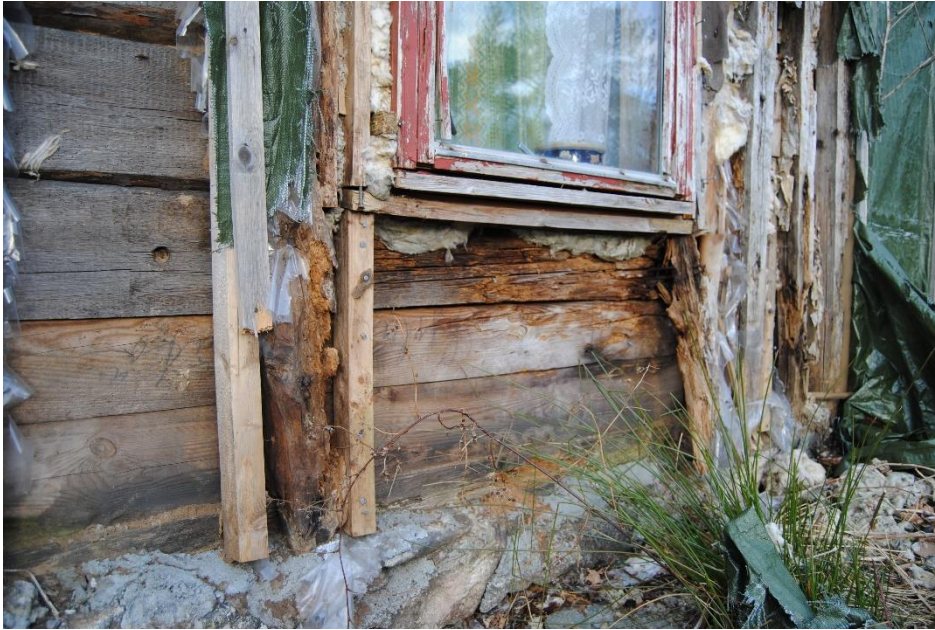
Råteskader i gavlvegg mot sør/øst.
