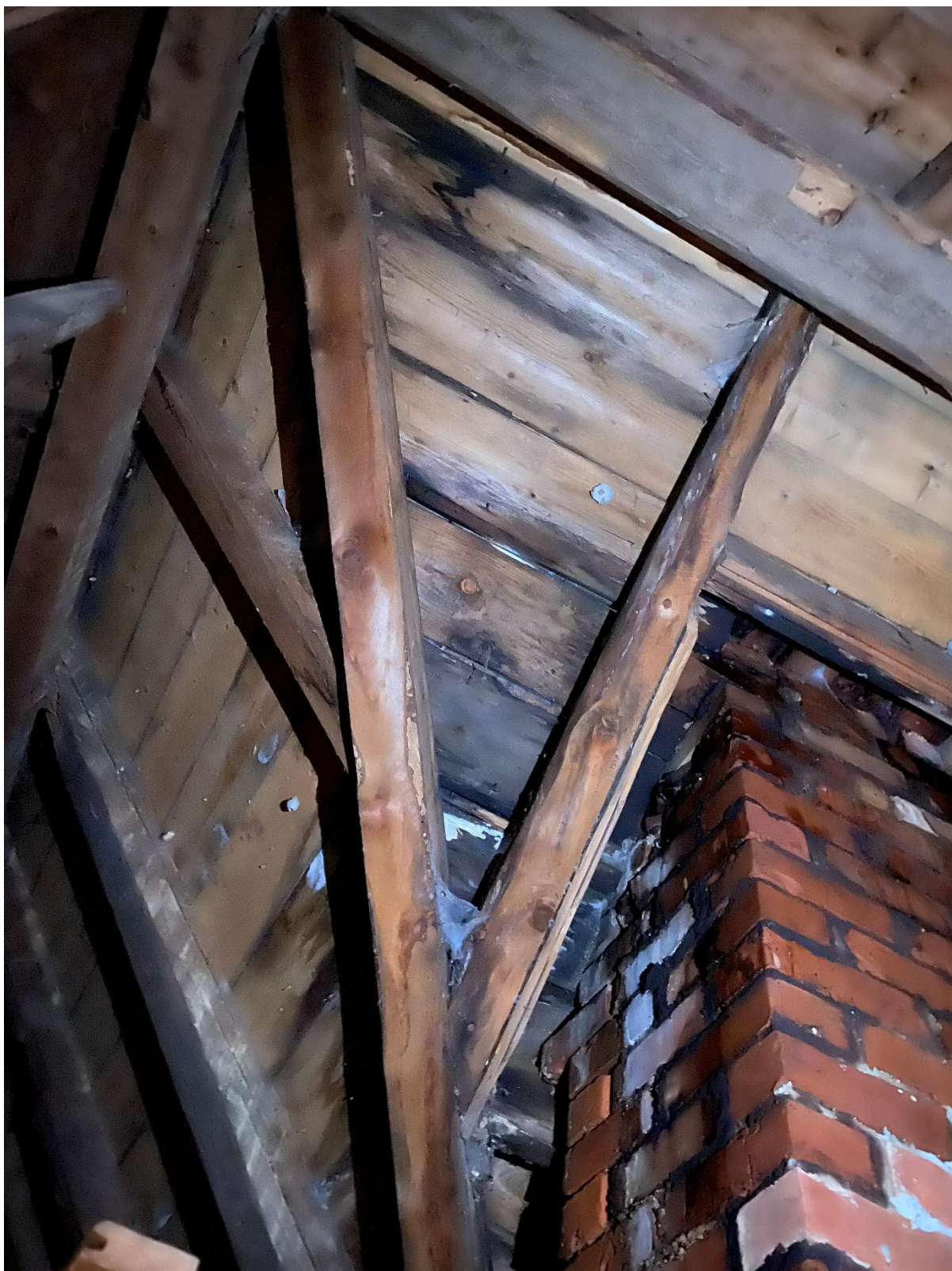
6 Lekasje ved sløysar og kring piper.
