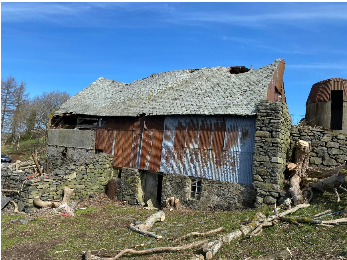
1Det er hol i taket fleire stadar, takkonstruksjon og berande konstruksjonar har kollapsa og vil snart ramle heilt ned.
