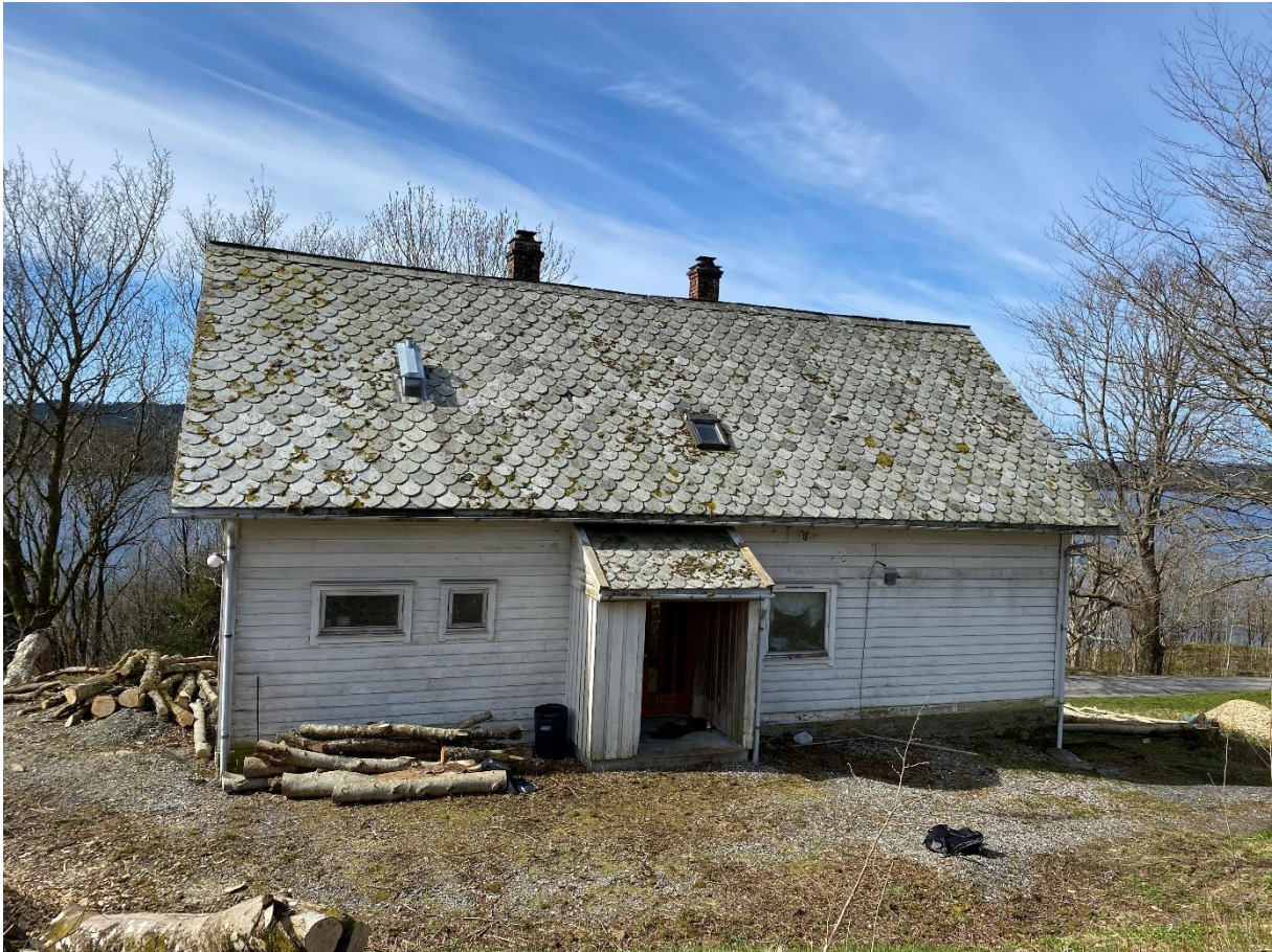
3Taket er mest truleg frå då huset var reist i 1926. Det er lekasje fleire stadar. Særleg kring piper, sløyser i ark og i takvindu.
