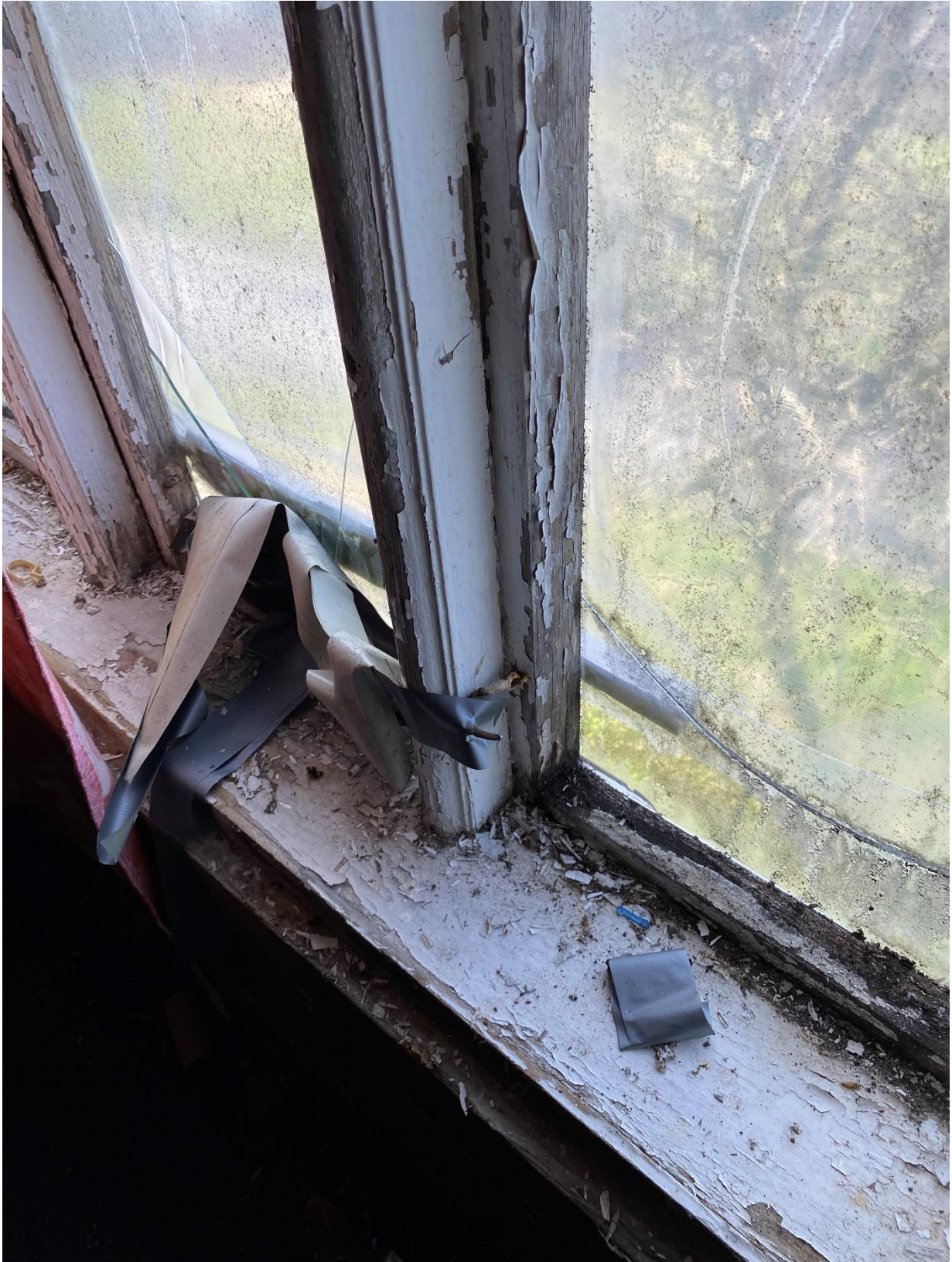
10 Tilstanden til dei eldre vindauga er varierende, men alle har behov for omfattande istandsetting/restaurering.
