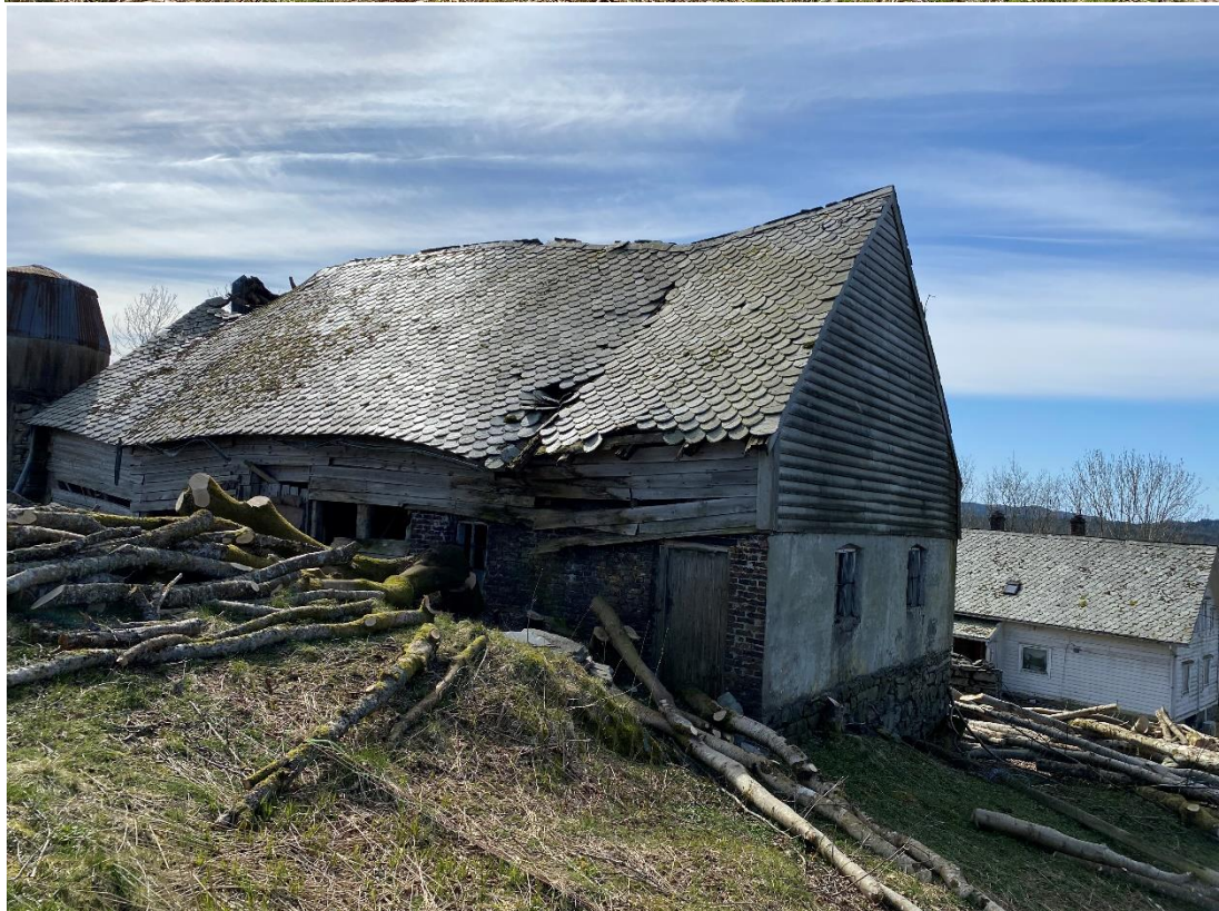
2 Det var ikkje spor etter gjenbruksmaterial i løa, bortsett frå i nore delen der det var to stavar som kunne sjå ut til å vere gjenbruk. Desse var kappd i lengda og var sterkt roteskadde.
