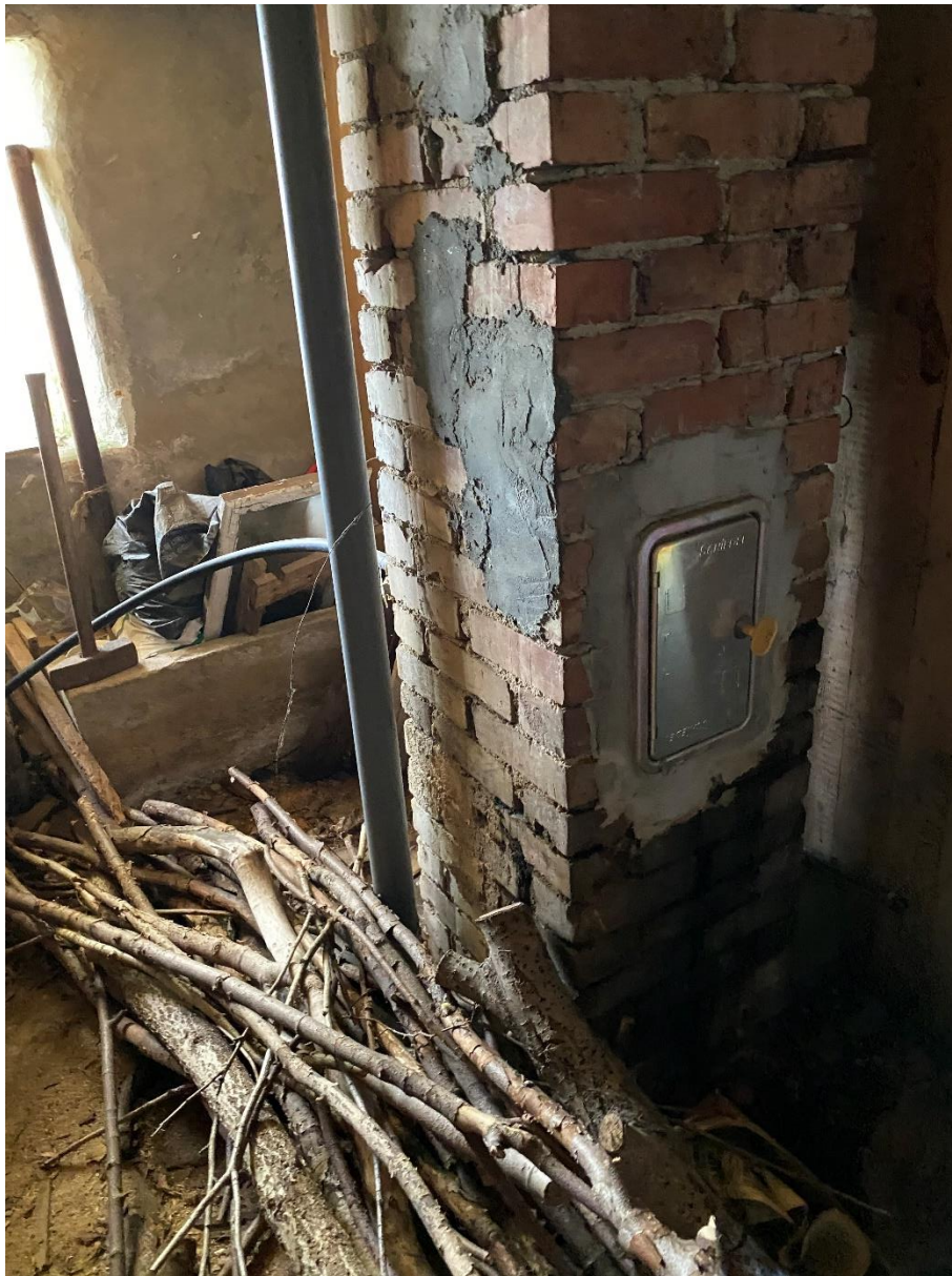
12 Den nordre pipa fekk ny foring på ikkje lenge før huset vart ståande tomt. Den søre pipa har ikkje vore i bruk på mange år. Det er lakasje kring begge.
