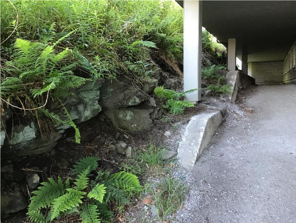
Figur 18. Delvis naturleg skråning bak skulehuset. Litt erosjon i massane.
