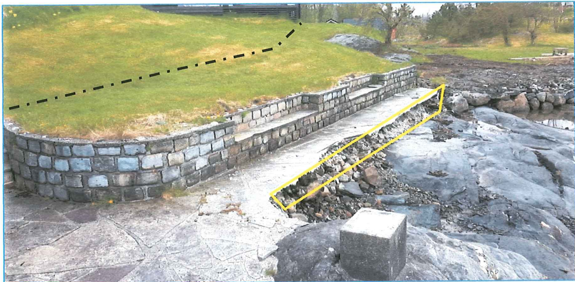
Figur 4: Gråsteinsmur og platting i skifer. Gul innmerking antyder hvor en evt betongmur anbefales for å hindre utvasking. Mørk stiptet linje antyder ca. hvor avløpsledningen ligger.
