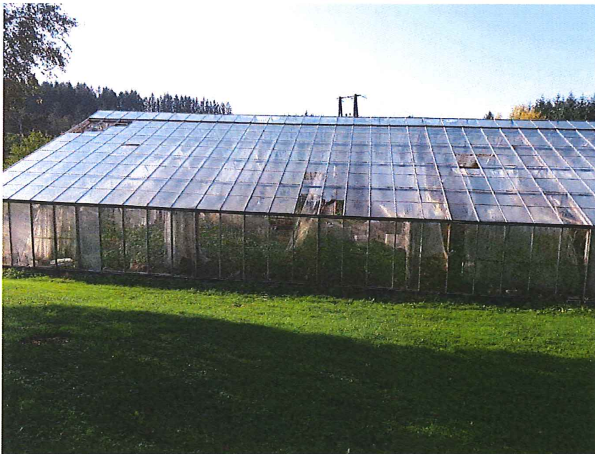
Bilde nr 8: Viser veksthus som nå ønskes revet. Som bildet tydelig viser, er veksthuset i svært dårlig forfatning.
