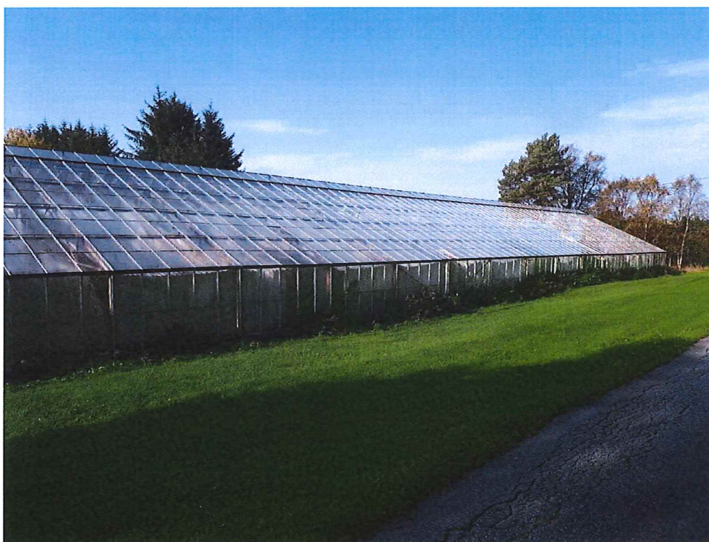
Bilde nr 6: Viser veksthus som nå ønskes revet. Som bildet tydelig viser, er veksthuset i svært dårlig forfatning.
