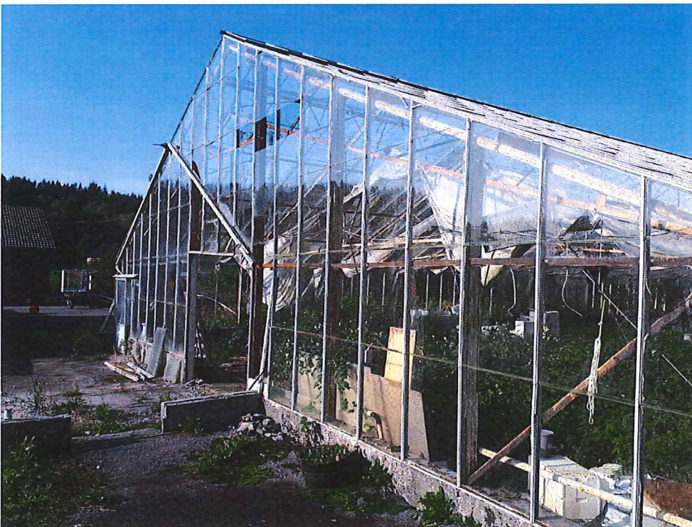
Bilde nr 4: Viser veksthus som nå ønskes revet. Som bildet tydelig viser, er veksthuset i svært dårlig forfatning.
